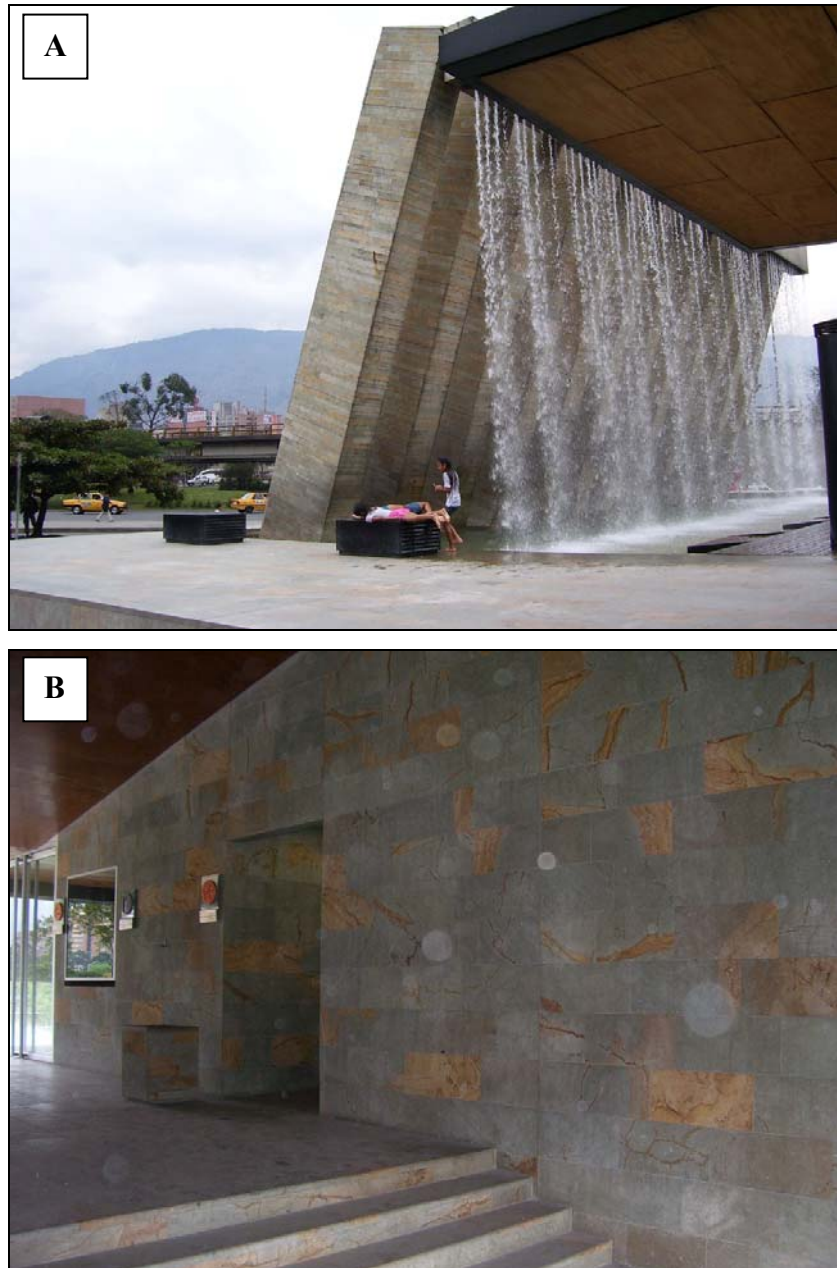
FIGURA 13. Uso do mesmo tipo de calcário em locais diferentes, gerando-se processos diferenciados de degradação, intenso por exposição permanente à corrente de água (A) e insignificante quando usado em muros internos (B).
