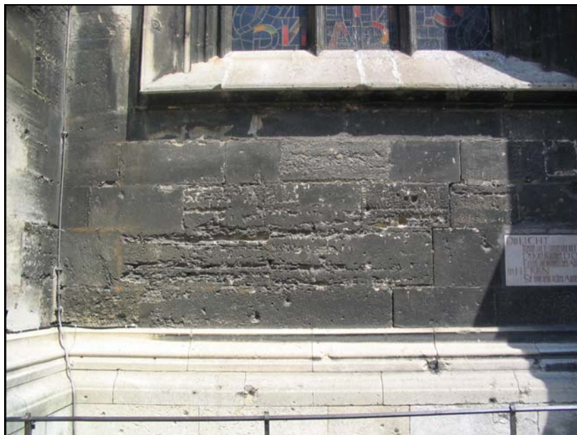
FIGURA 10. Alteração diferenciada ao longo do muro devido à intercalação de lâminas de argilito (depressões de relevo) com camadas finas de arenito. Fonte: Angeli, 2007.
