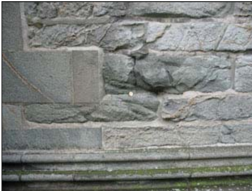
FIGURA 12. Deterioração diferenciada por escolha errada de materiais no processo de restauração. As rochas apresentam diferenças nas propriedades hídricas, que aceleram a degradação das mais antigas e ainda das novas. Fonte: Angeli, 2007.
