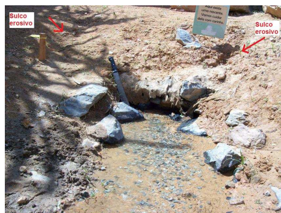
FIGURA 110 – Início de formação de pequenos sulcos erosivos a montante de N070.
