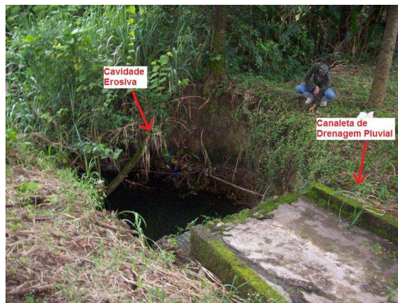
FIGURA 100 – Nascente antropogênica originada por cavidade erosiva à jusante de uma canaleta de drenagem pluvial (N078).
