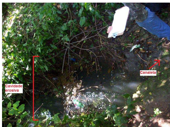
FIGURA 107 – Cavidade erosiva provocada pela concentração do escoamento pluvial (N066). Foto: Miguel F. Felipe
