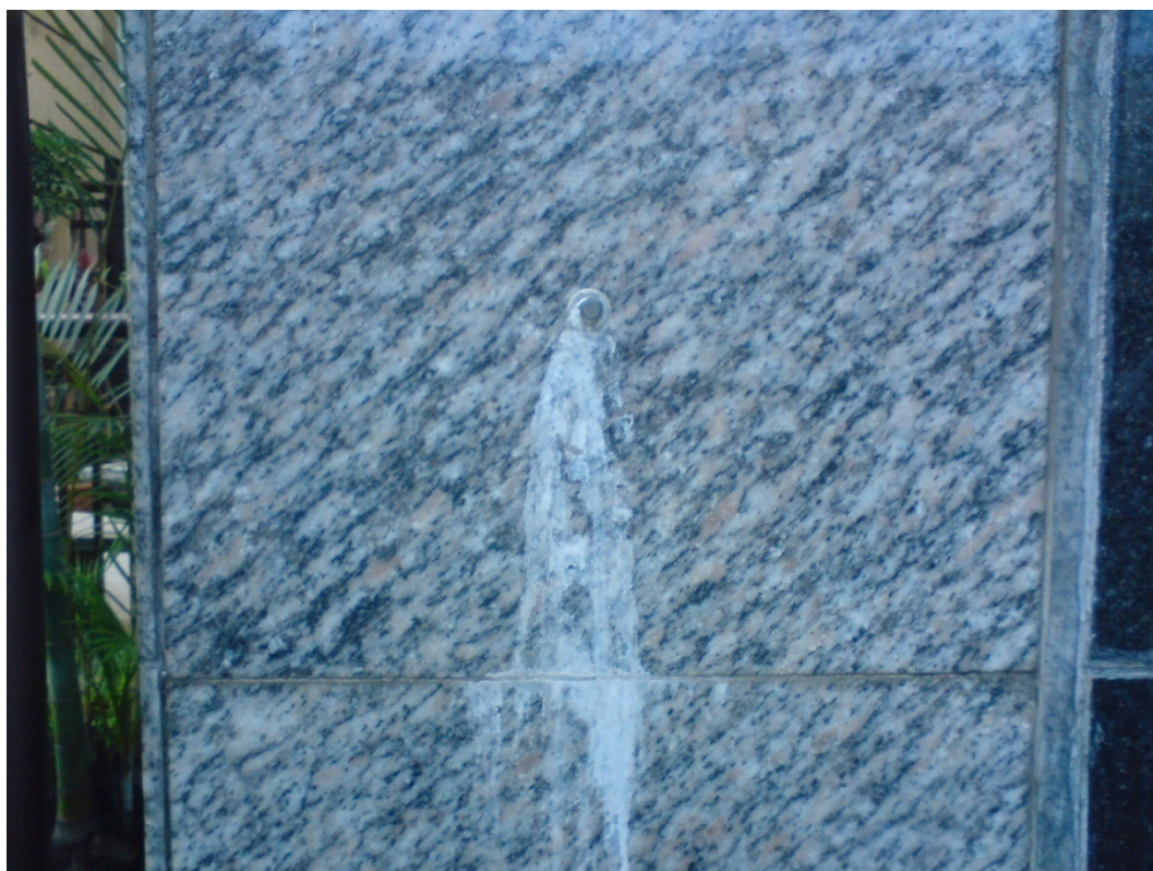
Figura 49-Utilização de parafuso sextavado sem adequada vedação, propiciando formação de eflorescências.
