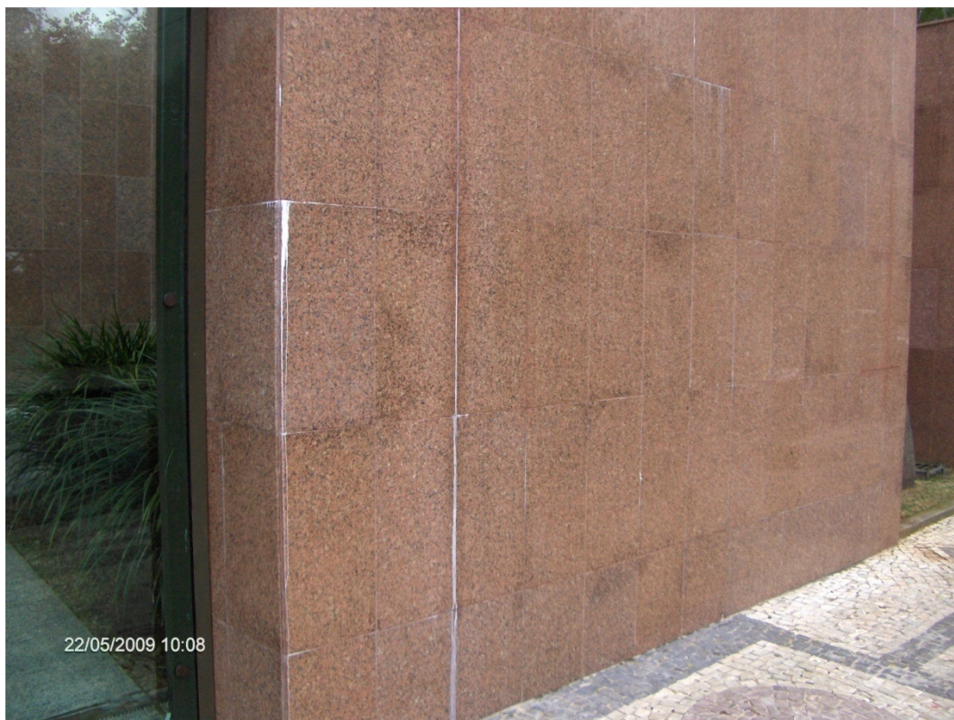
Figura 42-Formação de eflorescência em granito vermelho.
