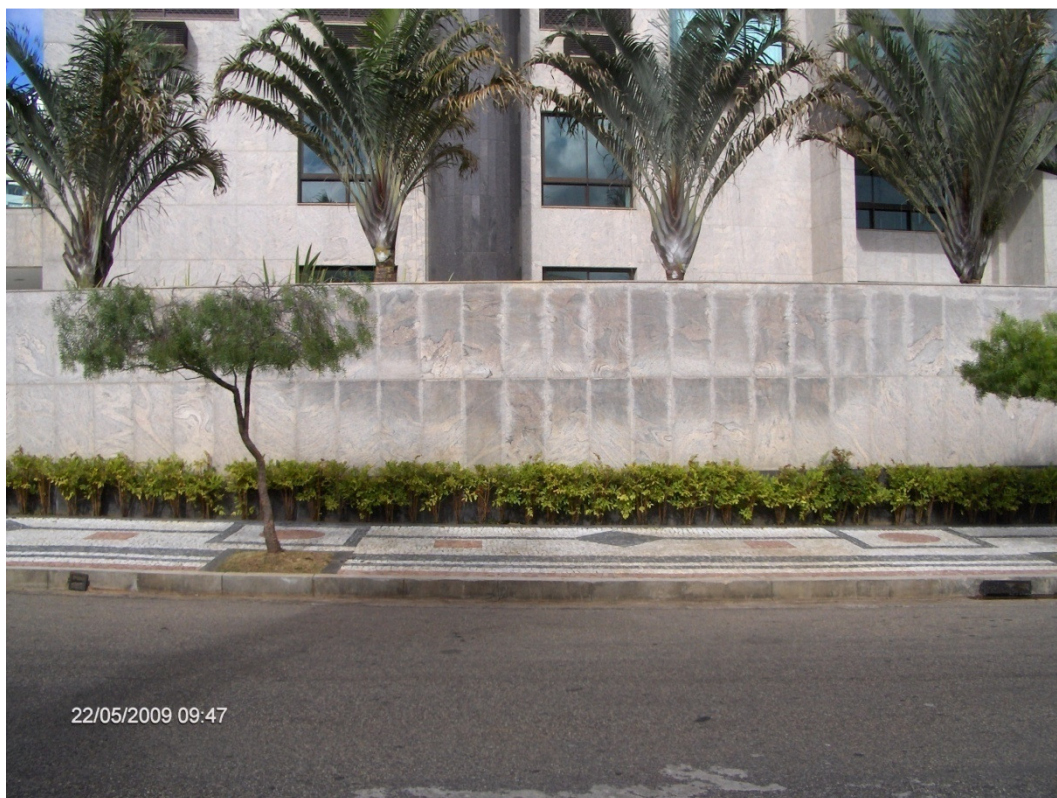
Figura 17-Revestimento manchado por umidade adjacente.
