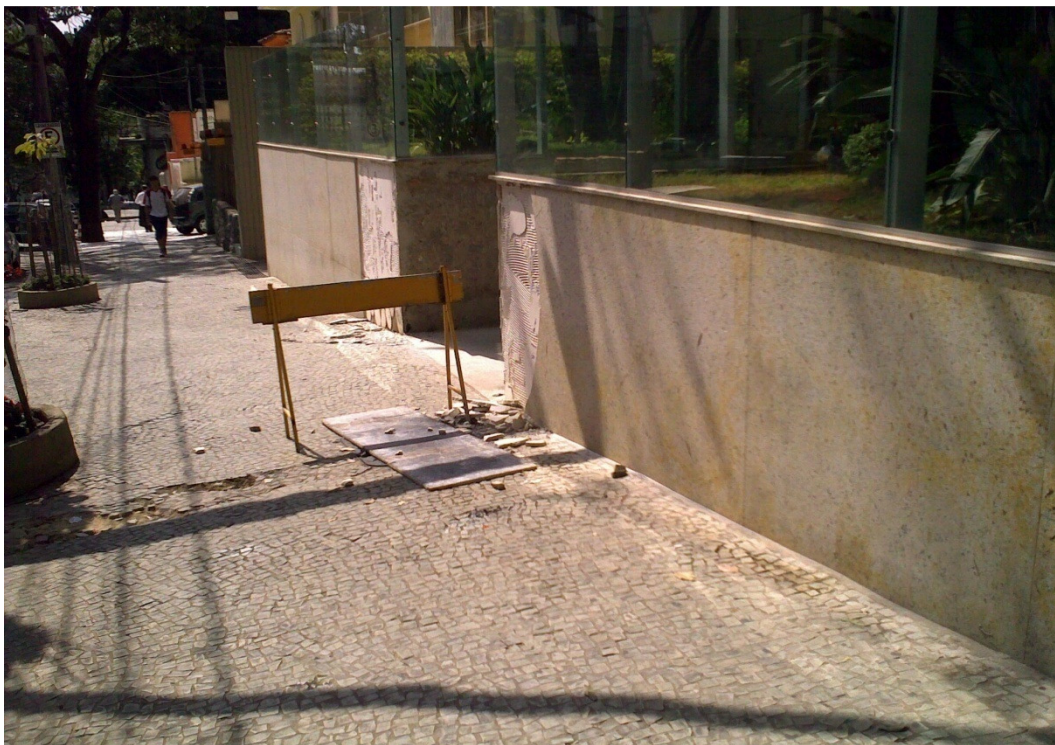
Figura 9-Utilização de argamassa colante branca, aplicada inadequadamente.
