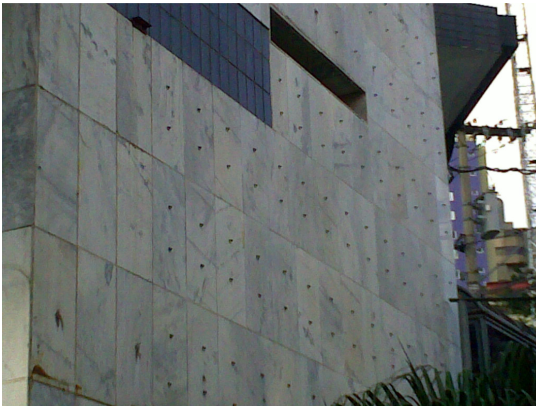
Figura 50-Utilização de parafuso tipo “castelo” interferindo na estética da fachada de mármore branco.
