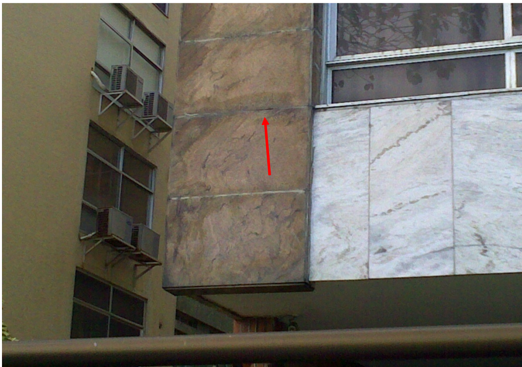
Figura 29-Utilização de rejuntamento inadequado (apenas cimentício), conduzindo à rápida deterioração
