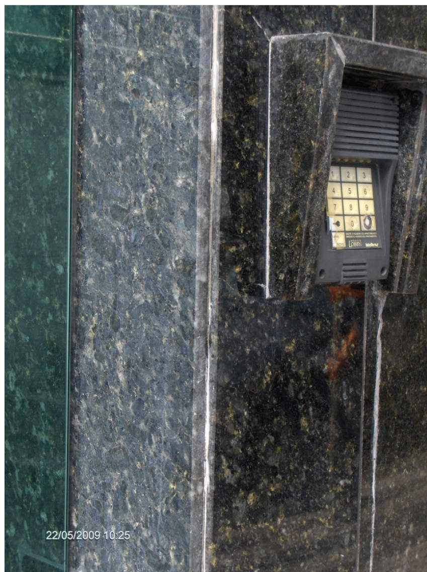
Figura 13-Granito cor verde escuro apresentando perda de coloração natural em função de aplicação de produtos de limpeza agressivos, insolação e oxidação.
