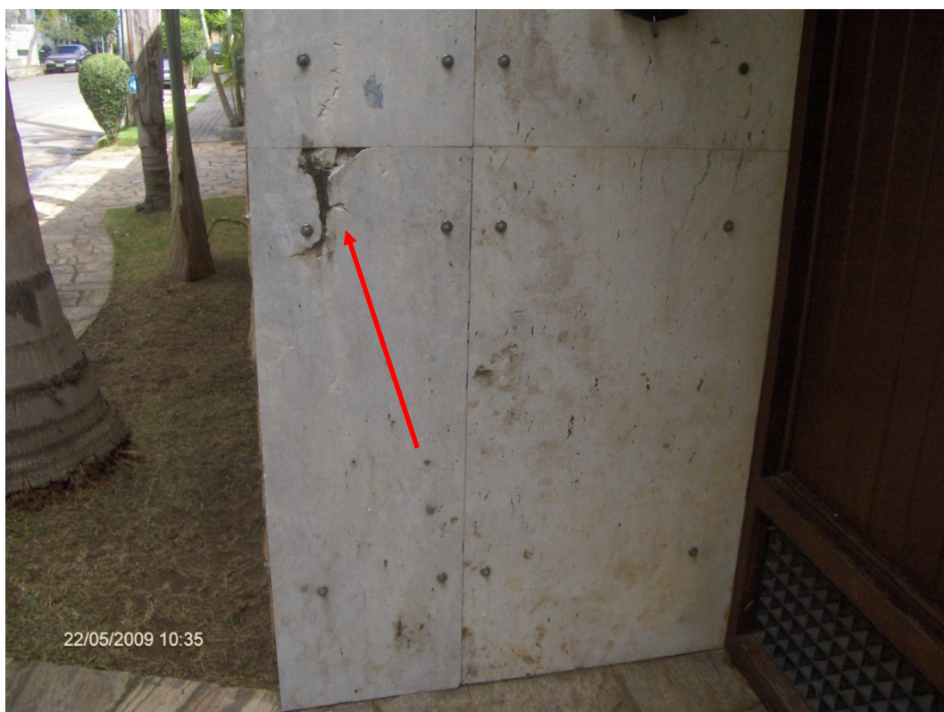
Figura 30-Cavidade surgida pela perda da resina de estucamento.
