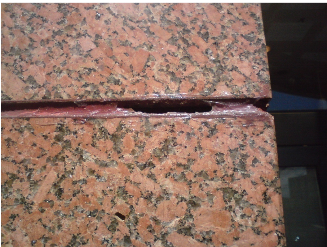
Figura 39-Ruptura do selante, que propiciará acesso e percolação da água.
