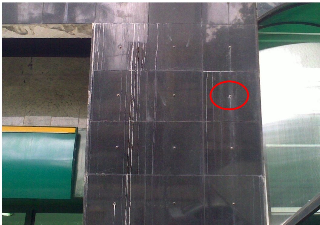
Figura 46-Ocorrência de eflorescências entre as placas e também nos elementos de reforço de ancoragem.
