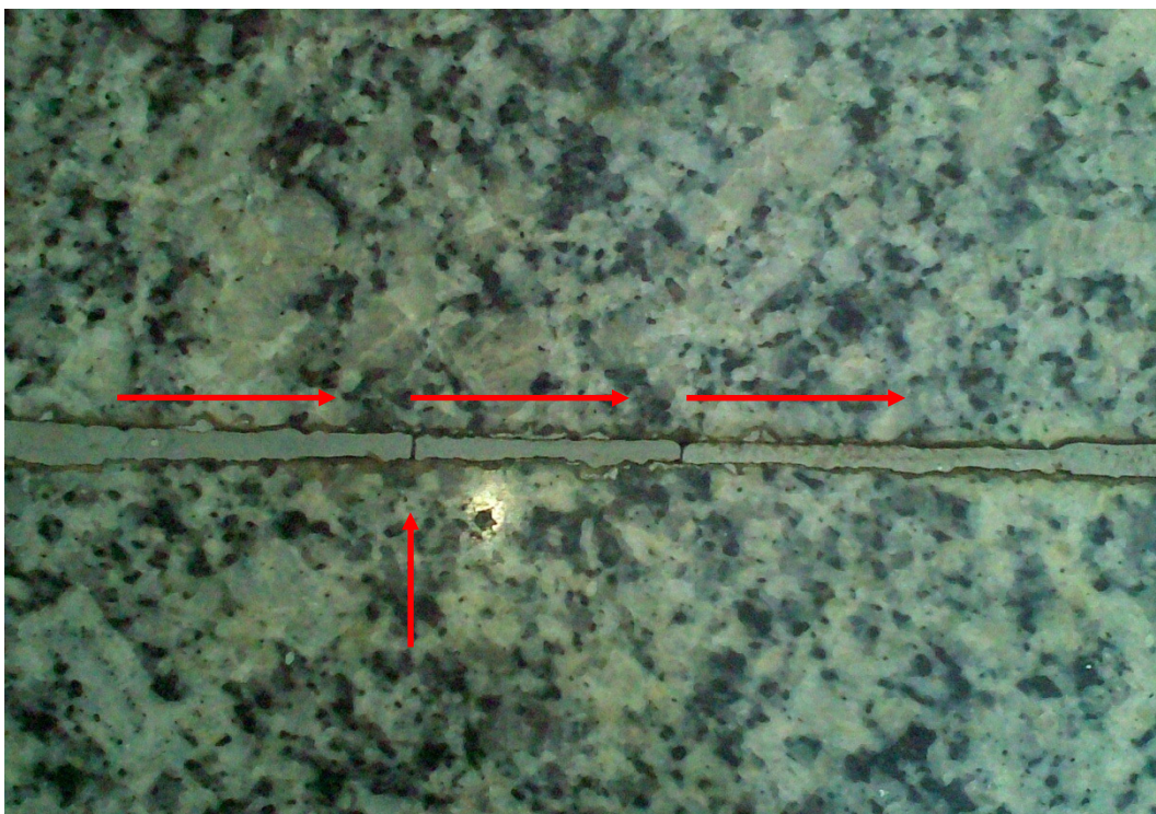
Figura 41-Detalhe de fissurações transversais e descolamento longitudinal do rejuntamento, por se tratar de material inadequado.
