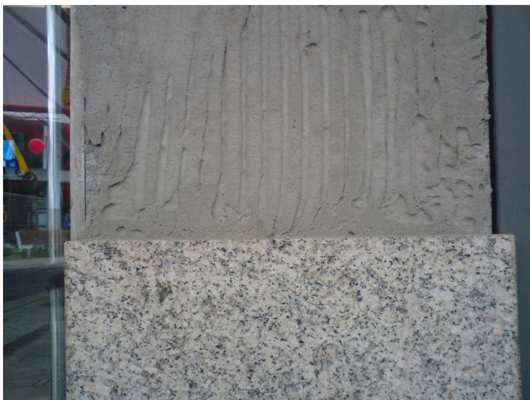
Figura 8- Aplicação deficiente de argamassa colante. Observar os vazios entre os cordões de argamassa.
