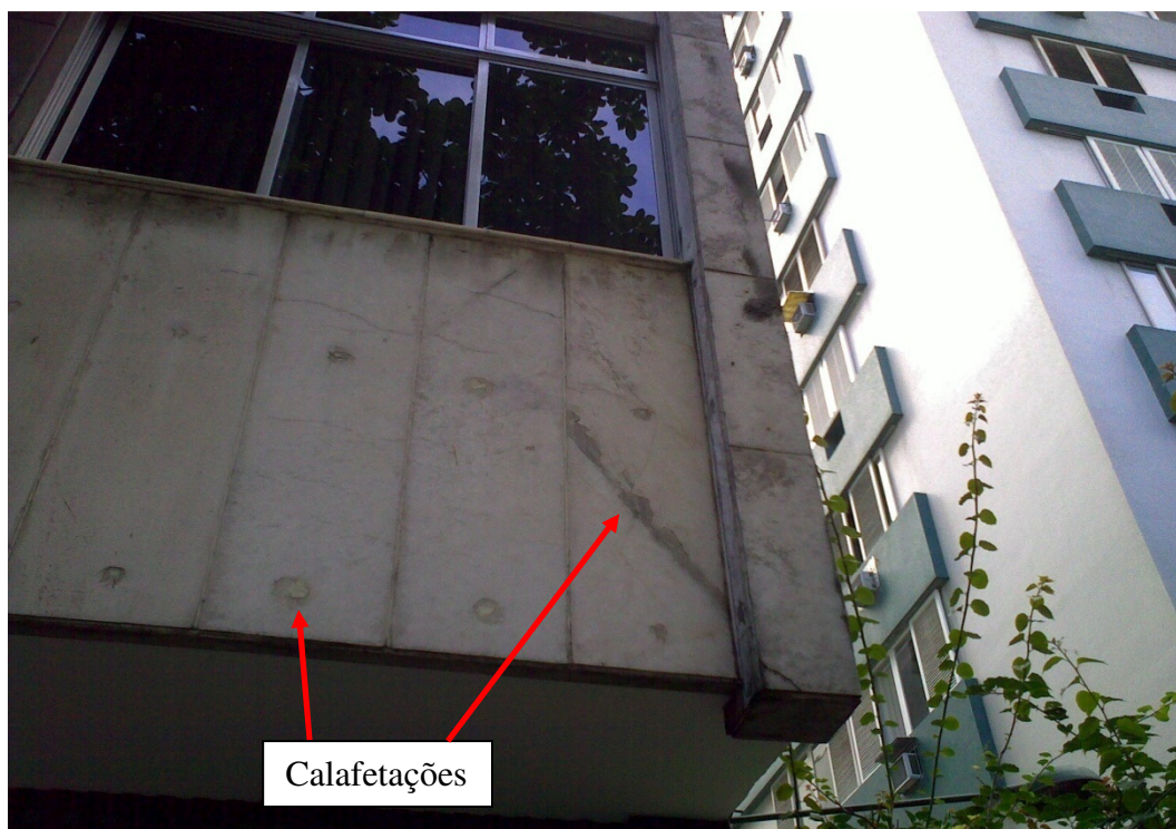
Figura 33-Fissuras generalizadas em revestimento de mármore e algumas calafetações com material não adequado.
