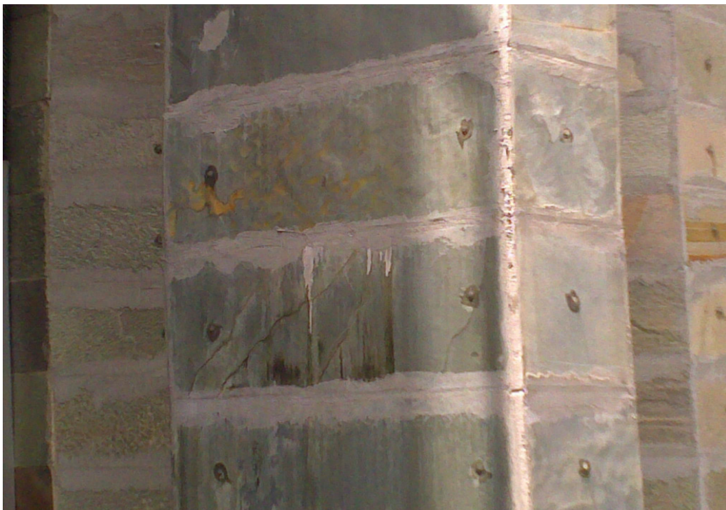
Figura 40-Além do uso de material inadequado (apenas cimentício) para rejuntamento, houve espalhamento na superfície das placas.
