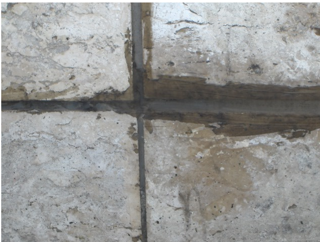
Figura 38-Manchamento das placas por uso de selante inadequado.
