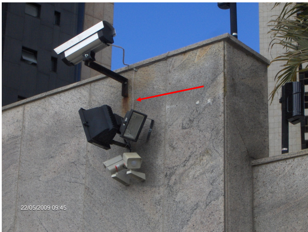
Figura 25-Liberação de ferrugem por suporte e infiltração por meio de soluções.
