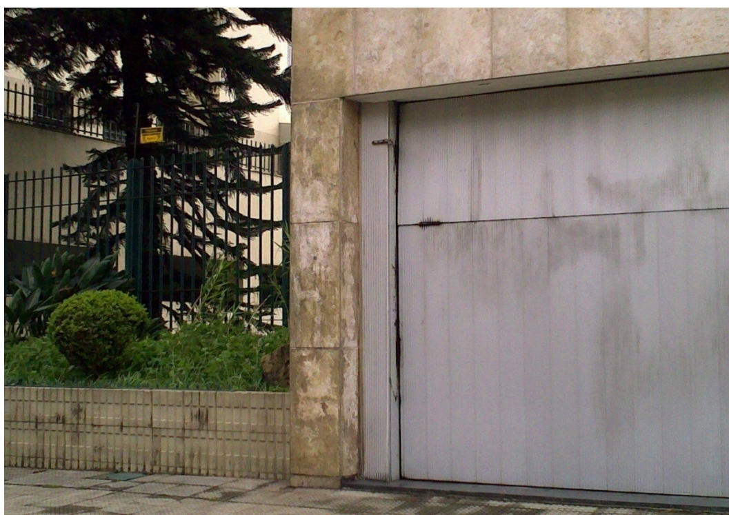
Figura 55-Incompatibilidade entre produto de proteção superficial e a rocha, provocando manchamento.
