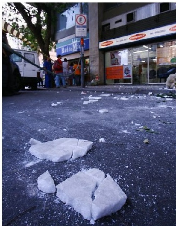
Figura 4-Destacamento e posterior queda de placa de mármore em movimentada rua no centro do Rio de Janeiro, evidenciando risco potencial de acidente.
