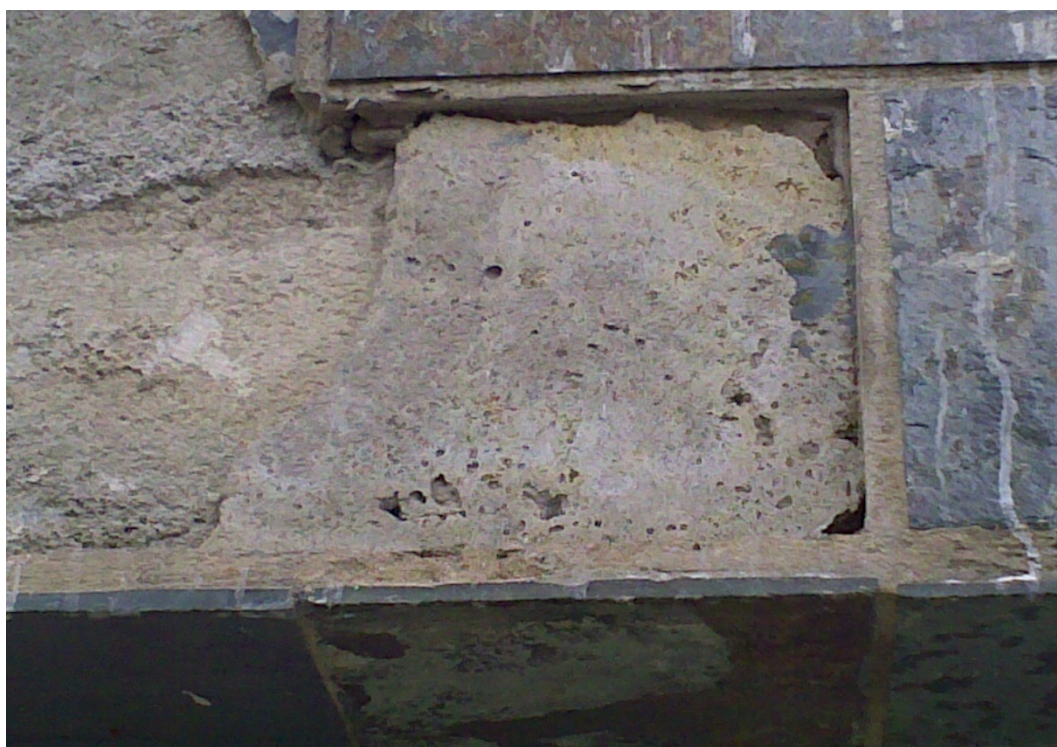
Figura 7-Argamassa com plasticidade inadequada, o que impede o total preenchimento do verso da placa de rocha.
