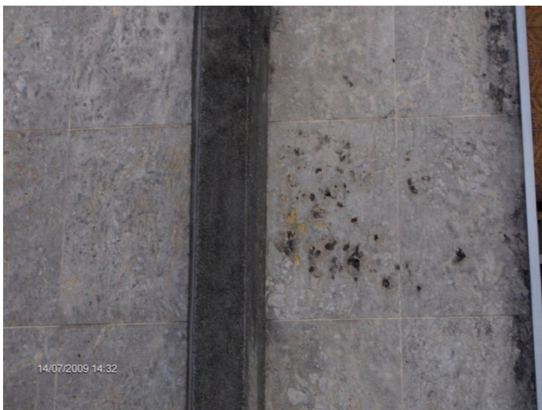
Figura 36-Detalhe da deterioração de fachada salientando algumas fendas.
