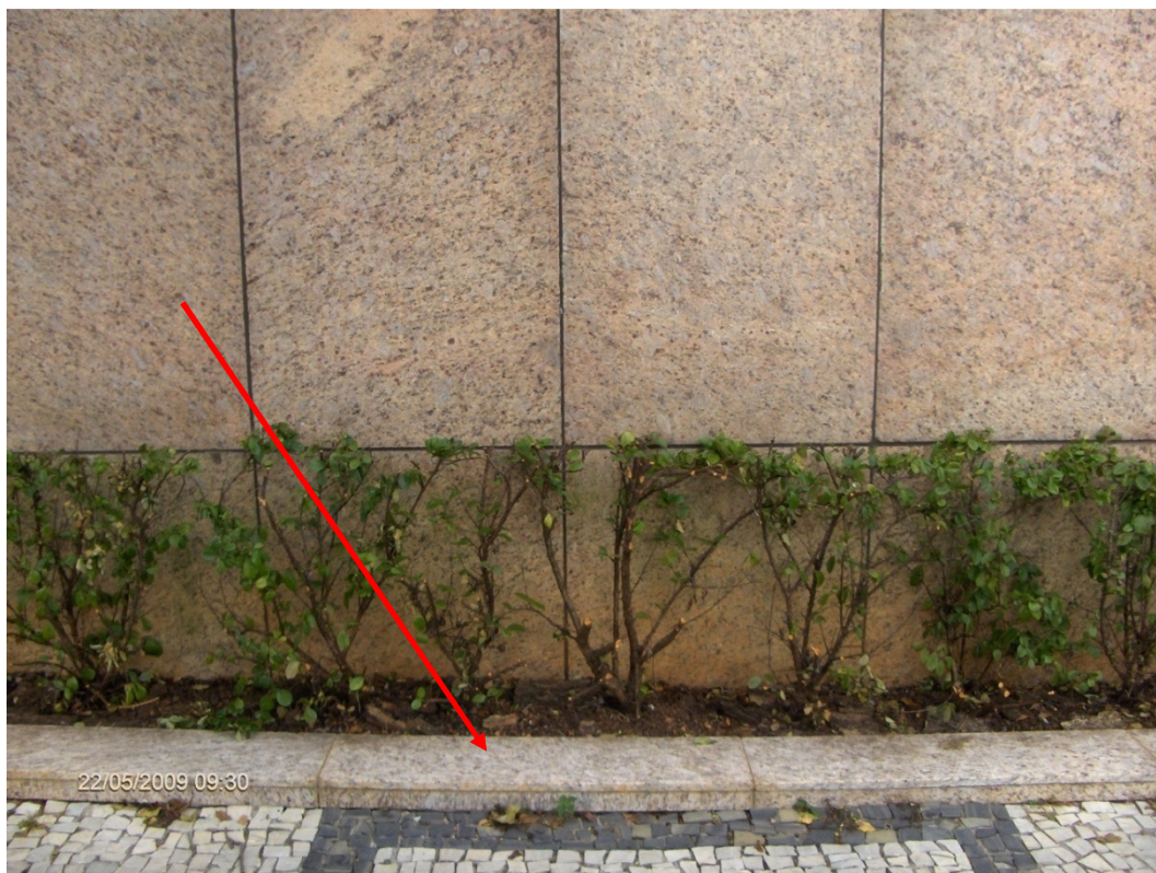
Figura 14-Detalhe da perda de cor por lixiviação e/ou efeito de umidade ascendente nas placas. As peças aplicadas na primeira fiada horizontal apresentam coloração diferente em relação às verticais e às superiores.
