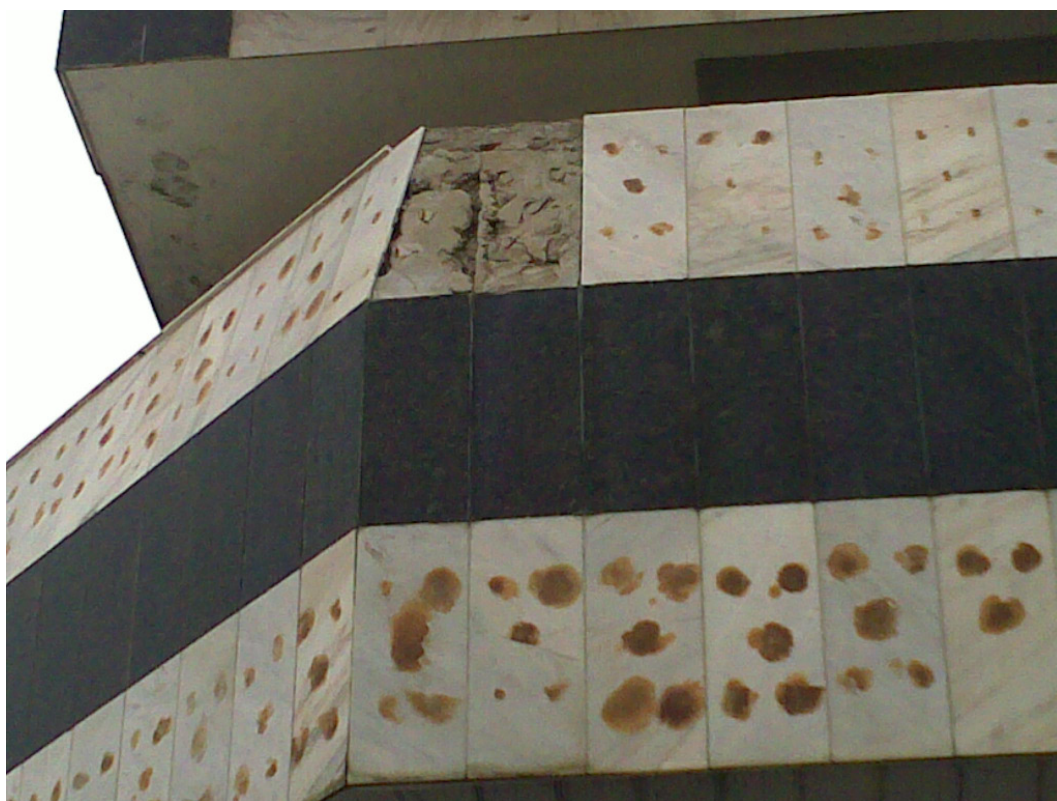
Figura 48-Detalhe de descolamento de placas de revestimento na fachada lateral e também da inadequada plasticidade da argamassa de assentamento.
