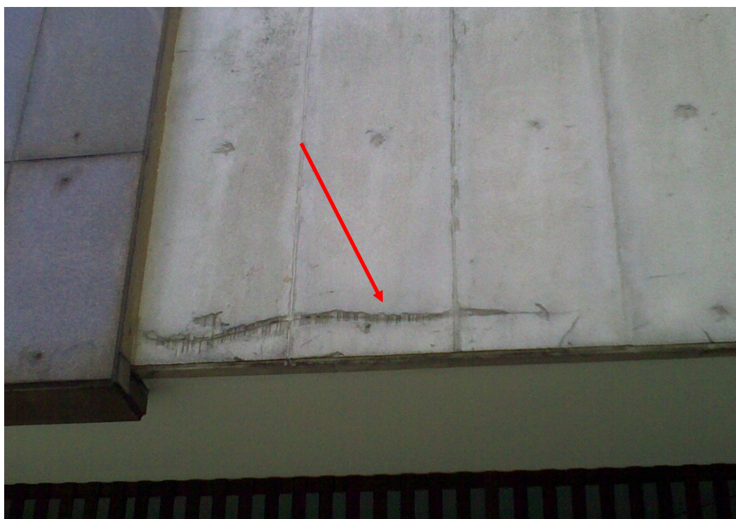
Figura 31-Preenchimento de trinca com material inadequado.
