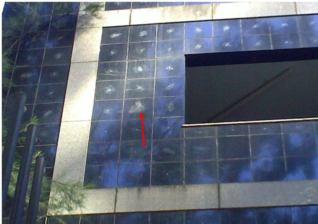
Figura 52-Placas de gabro manchadas pela colmatação da cabeça dos parafusos.
