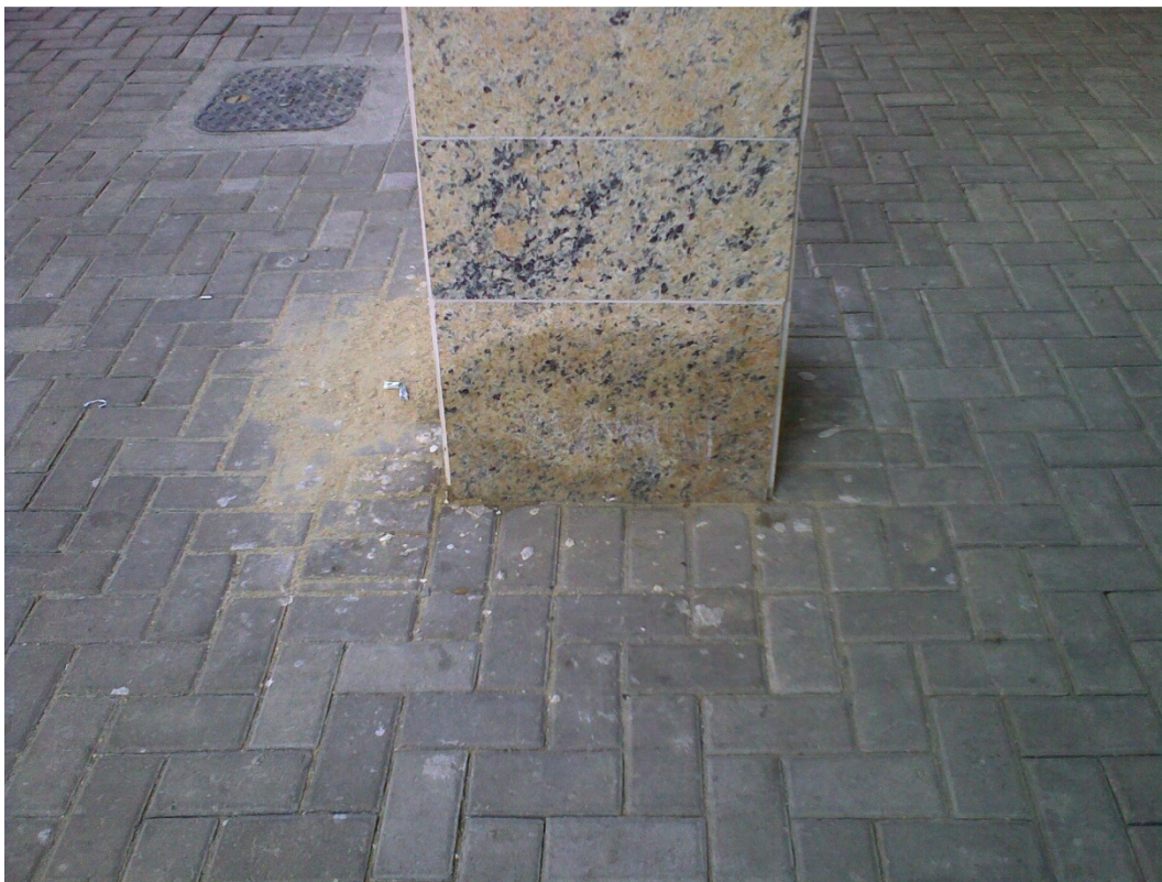
Figura 18-Ascensão capilar por insuficiente impermeabilização da fundação.
