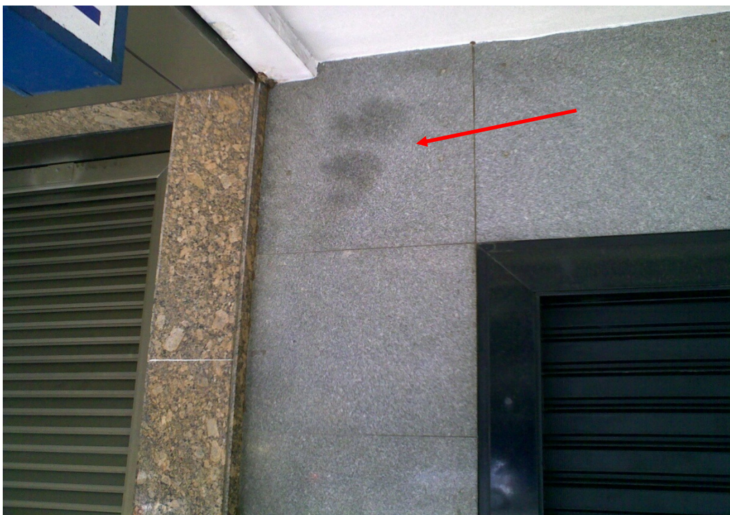
Figura 27-Manchas devidas possivelmente ao excesso de água de amassamento.
