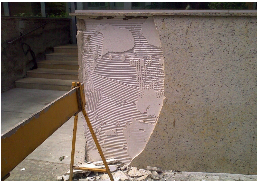
Figura 10-Detalhe da vista lateral direita da mesma edificação, evidenciando a falha de aplicação, o que propiciou pequena área efetiva de contato entre a argamassa e a placa de rocha.
