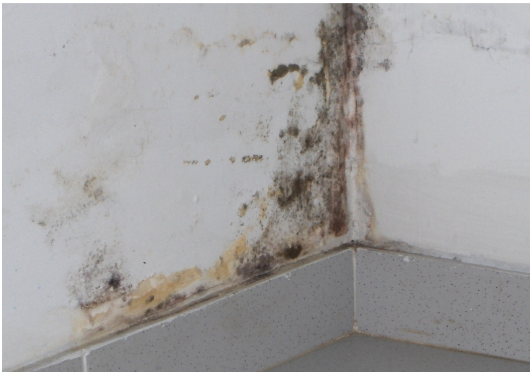
Figura 5-Aparecimento de mofo e bolor dentro de uma edificação em função de infiltrações que ocorreram na fachada.
