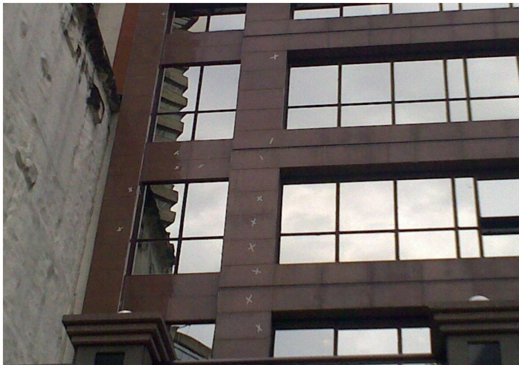
Figura 37-Fachada com comprometimento de sua estabilidade. As peças identificadas com fita adesiva estão em iminente risco de queda.
