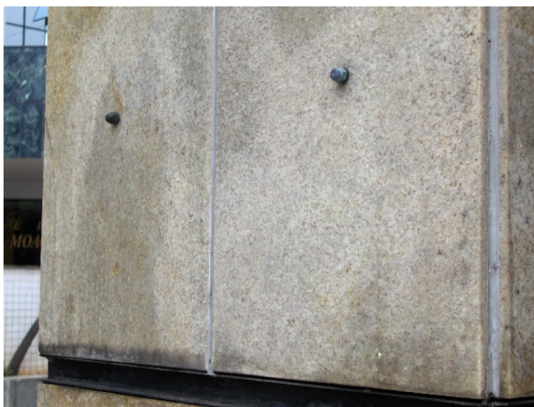
Figura 72-Comprometimento estético de fachada pela furação não alinhada, parafusos diferentes e oxidados além de manchamentos possivelmente oriundos de penetração de água pelos seus furos.
