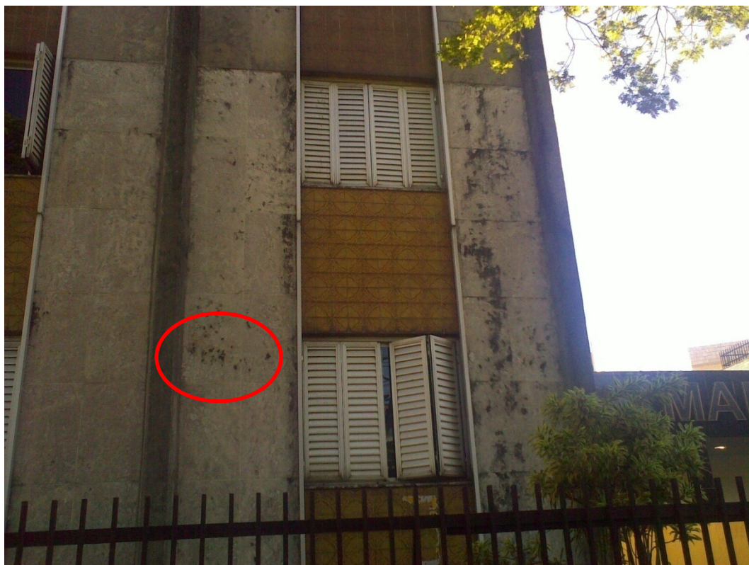
Figura 35-Revestimento degradado e com presença de manchas negras em função da ancoragem de fuligem presente na atmosfera.
