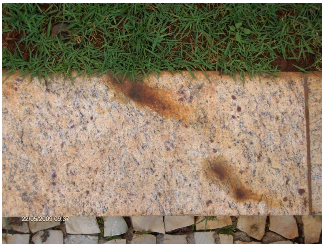
Figura 22-Mancha devido à liberação de óxidos e hidróxidos de ferro.
