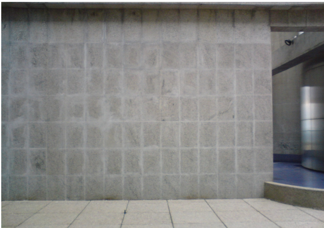
Figura 26-Contaminação generalizada da rocha devido à presença de óxido de ferro no cimento presente na argamassa.
