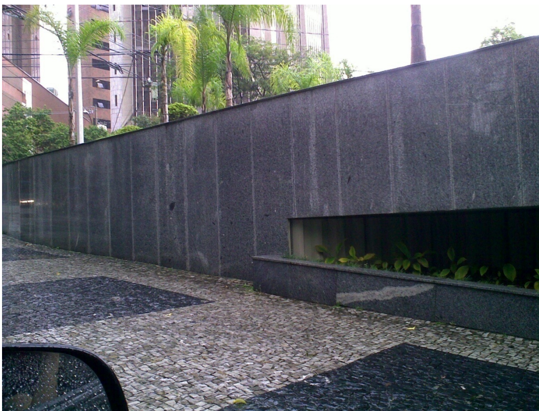
Figura 19-Aparecimento de manchas provocadas pela água da chuva.
