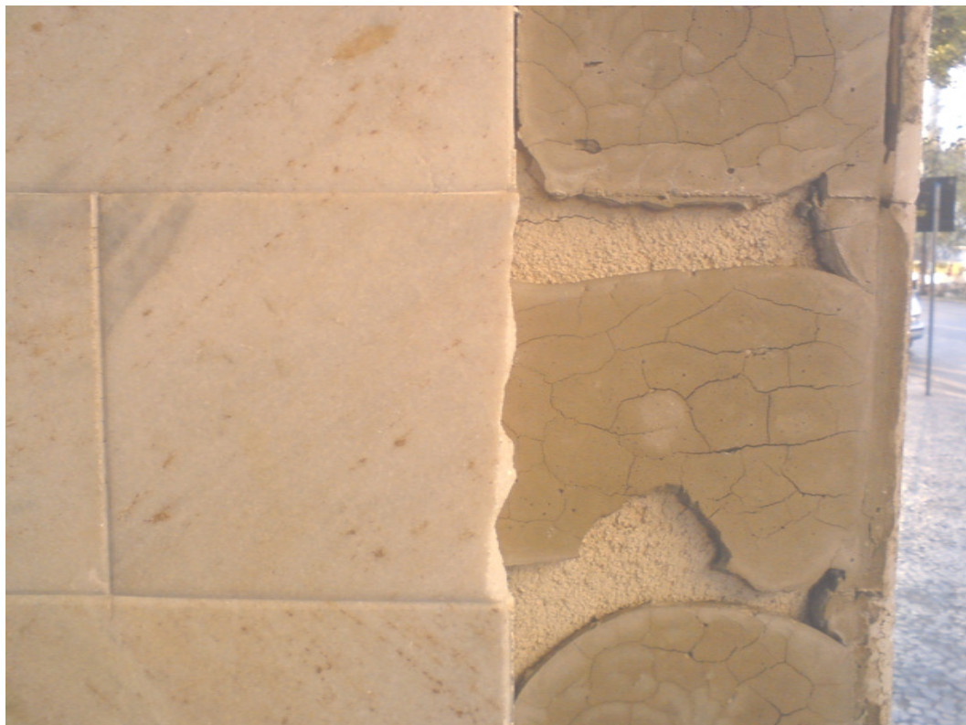
Figura 6-Fissuração da argamassa de assentamento provocando descolamento.
