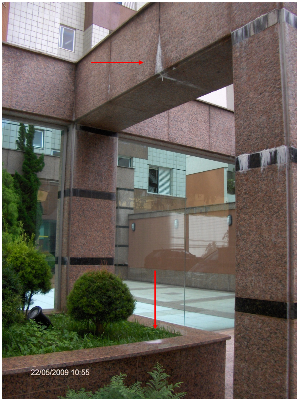
Figura 44-Eflorescência em revestimento de granito e também gotejamento.
