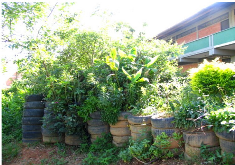
Figura 12: Reaproveitamento de pneus para contenção de encosta na horta comunitária do COMUPRA, bairro Ribeiro de Abreu (BH, 2008). Fonte: REDE.
