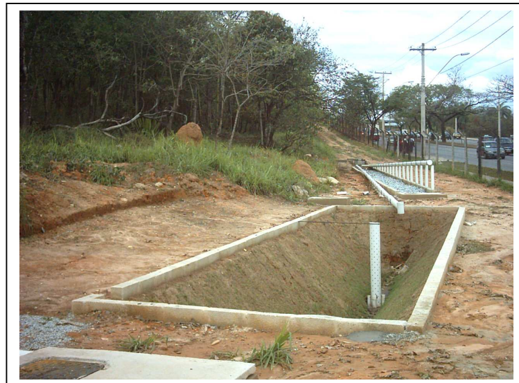
FIGURA 10 - Vista das estruturas do experimento de infiltração de águas pluviais urbanas (vala de detenção no primeiro plano e trincheira de infiltração no segundo plano), instalado em área com declividade de 4,5%; condutividade hidráulica média do solo de k= 5,21 \times 10^{-5} m/s e profundidade do N. A. (Nível d'Água) maior que 4 metros.
