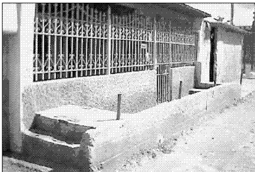
Figura 40 – Exemplo de residência no bairro Veneza próxima a um canal, onde o morador improvisou um muro com objetivo de evitar a entrada de água durante as cheias.
