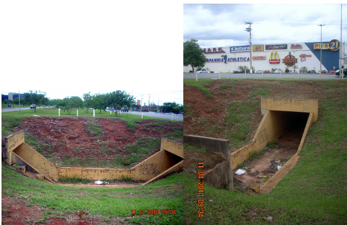
Figuras 62 e 63 - Vistas do túnel no canteiro central em frente ao Shopping Píer 21. Com lixo acumulado, demonstra o descaso com os locais públicos tanto do particular (Píer 21) quanto do poder público, pois, não tamparam e nem recuperaram a área, retornando-a como era antes, sendo perceptível na foto 56 claramente a diferenciação.
