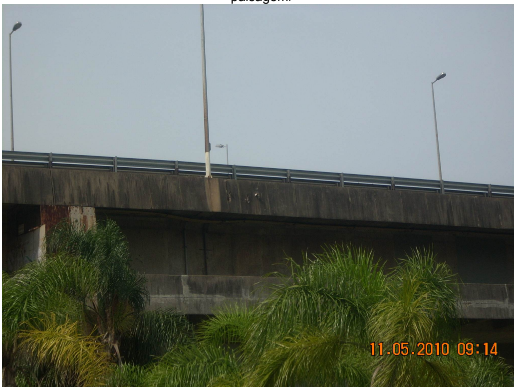
Figura 72- Vista lateral da Ponte Colombo Salles, com destaque para os guard rails colocados que se diferenciam da estrutura original da ponte.
