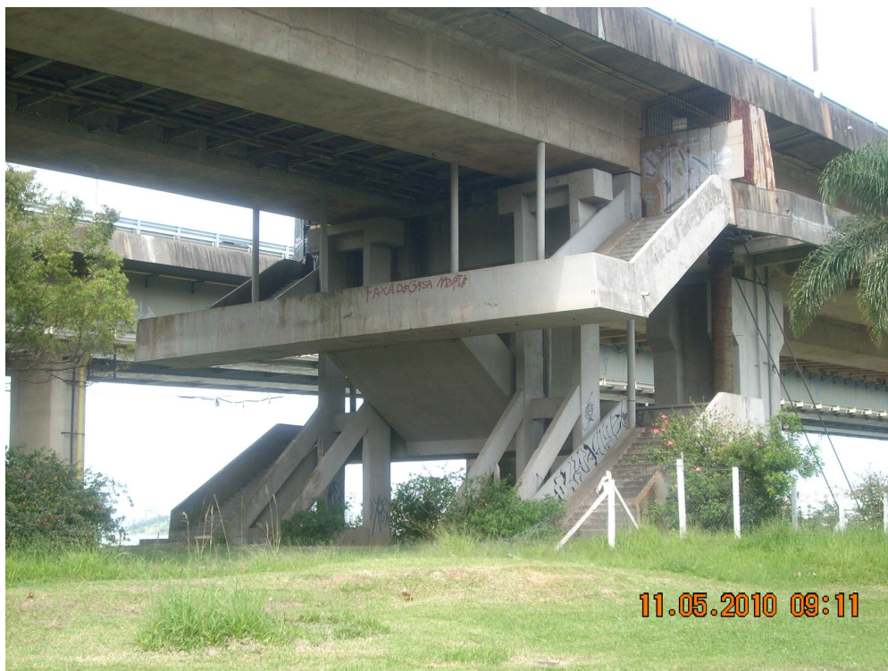
Figura 71 - sob a Ponte Colombo Salles, neste local percebe-se a existência de uma passarela sob a ponte que, reabilitada poderia ser utilizada por pedestres para observação da paisagem e circulação por bicicletas e caminhadas, mantendo a relação de proximidade entre os cidadãos e a paisagem.
