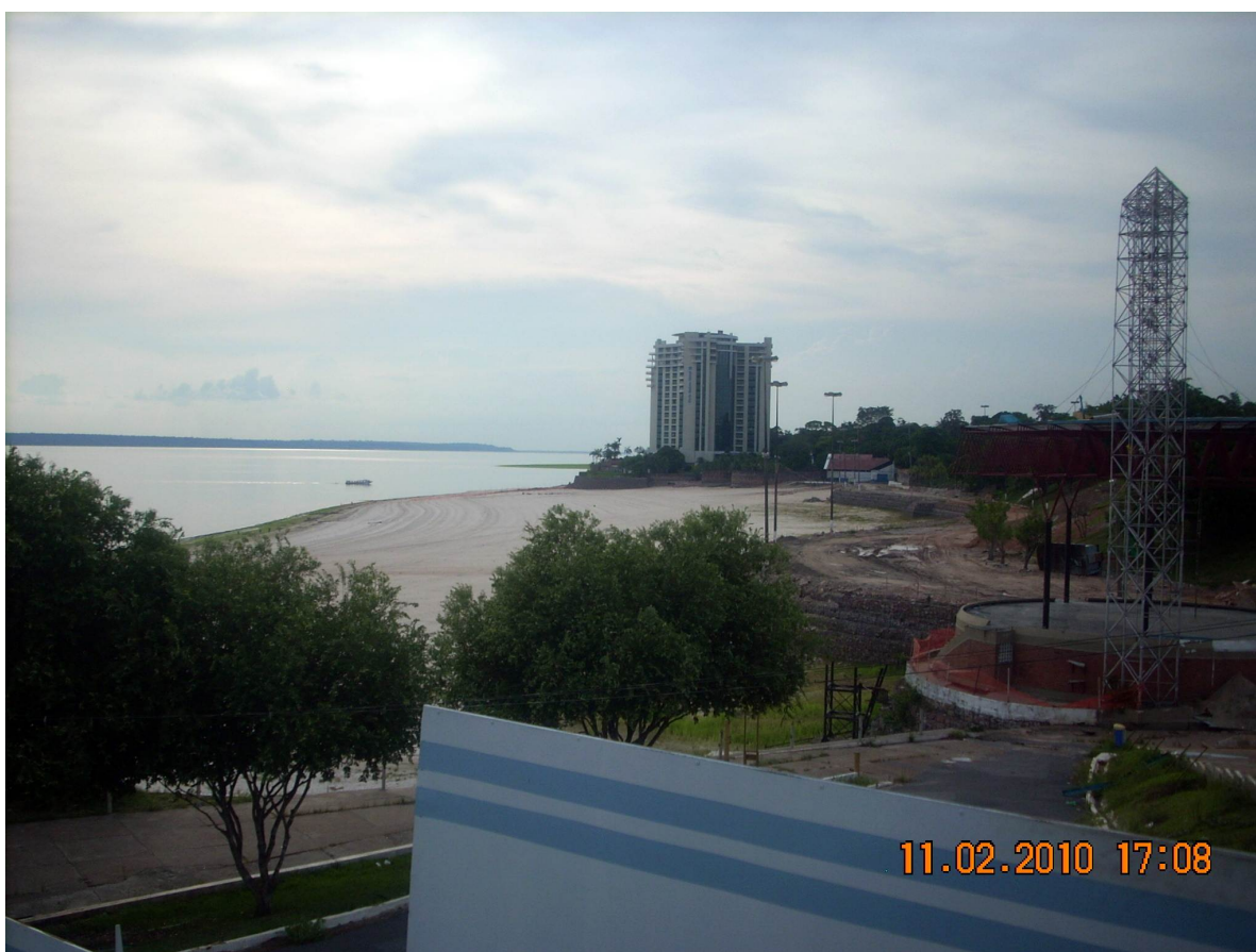
Figura 47 - Obras em Ponta Negra hoje, onde se percebe o delinear da nova área de lazer. Ao fundo o Hotel Tropical.
