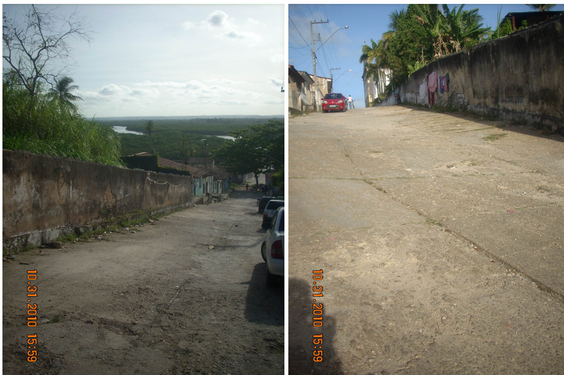
Figura 56 e 57 - Ladeira Porto da Banca, demonstrando as placas de cimento colocadas e seu desgaste.
