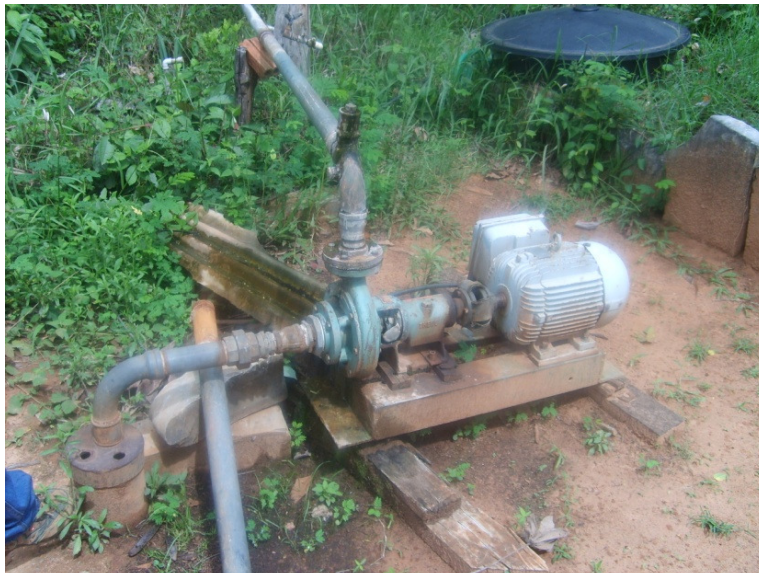
FIGURA 7 – Captação de água do poço tubular em Roda D'água, município de Januária-MG Fonte: SILVA, 2009.
