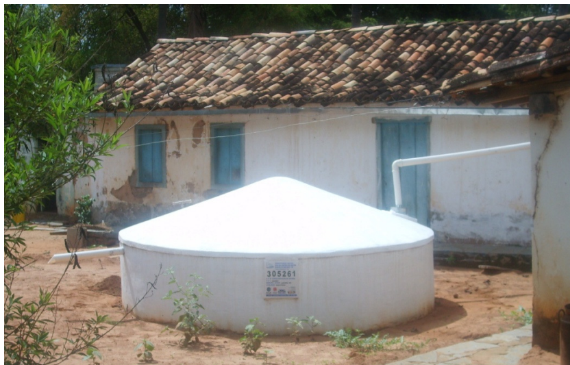
FIGURA 8 – Cisterna de Placas construída através do Programa Um Milhão de Cisternas Rurais – P1MC na comunidade de Roda D'água, município de Januária-MG Fonte: SILVA, 2009.
