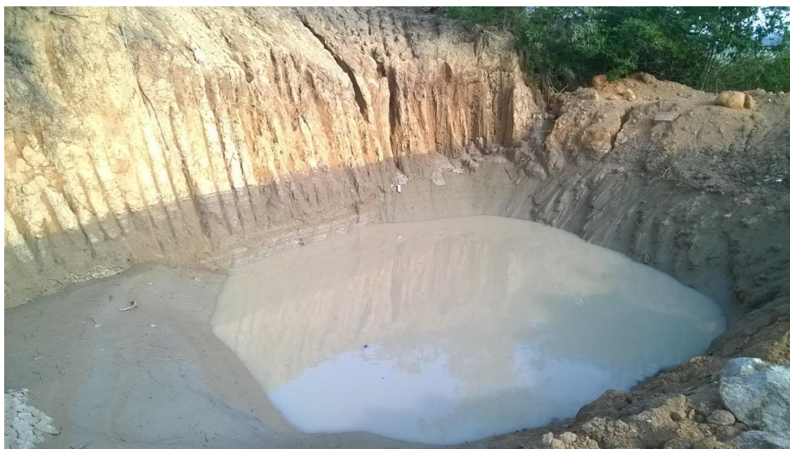
Foto 10. Obras realizadas como o uso da retroescavadeira – Barraginhas e Bacias de Contenção.
