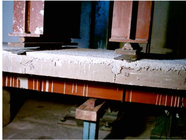
Figura 5.34 – Qualidade do concreto moldado sobre painéis de CCA, modelo Viga CCA 04
