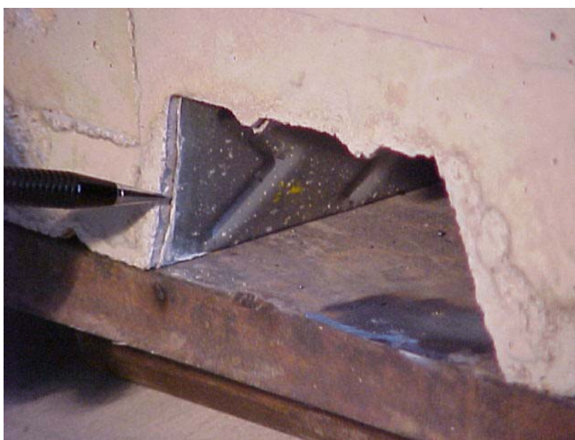
FIGURA 3.4 - Detalhe do deslocamento horizontal relativo entre a fôrma de aço e o concreto (end-slip)
