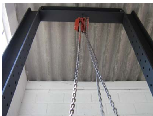
(d) talha e pórtico
