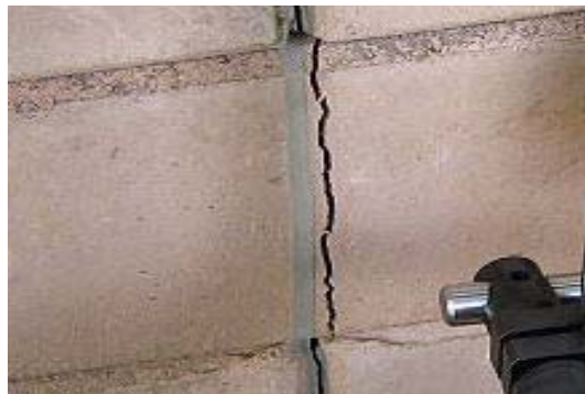
(b) trinca de face tipo 2
