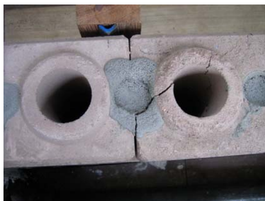
(d) trinca de topo tipo 1
