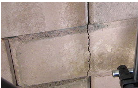
(a) trinca de face tipo 1
