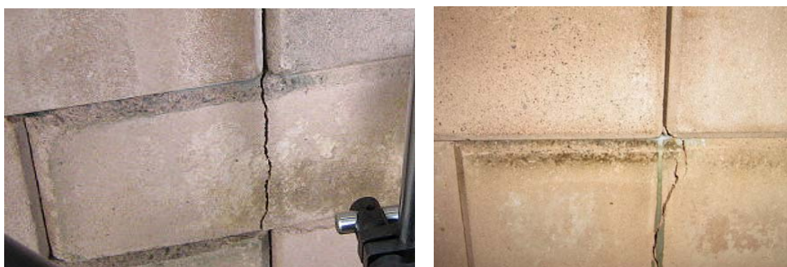
(a) trinca típica no centro do bloco
