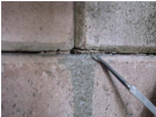
(a) abertura da junta
