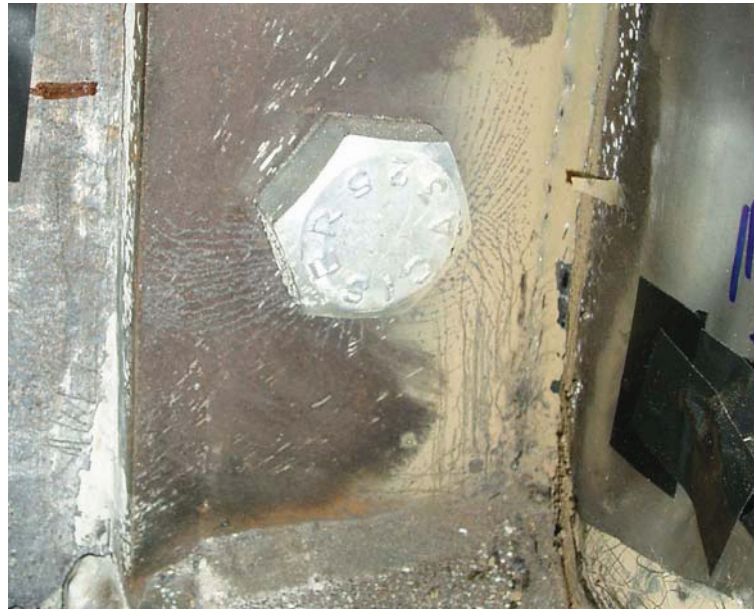
FIGURA 3.11 – Linhas de LÜDER na chapa em torno dos parafusos
