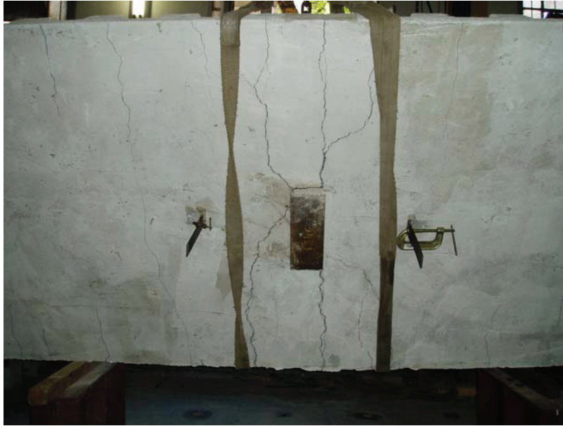
FIGURA 3.9 – Fissuras na laje de concreto
