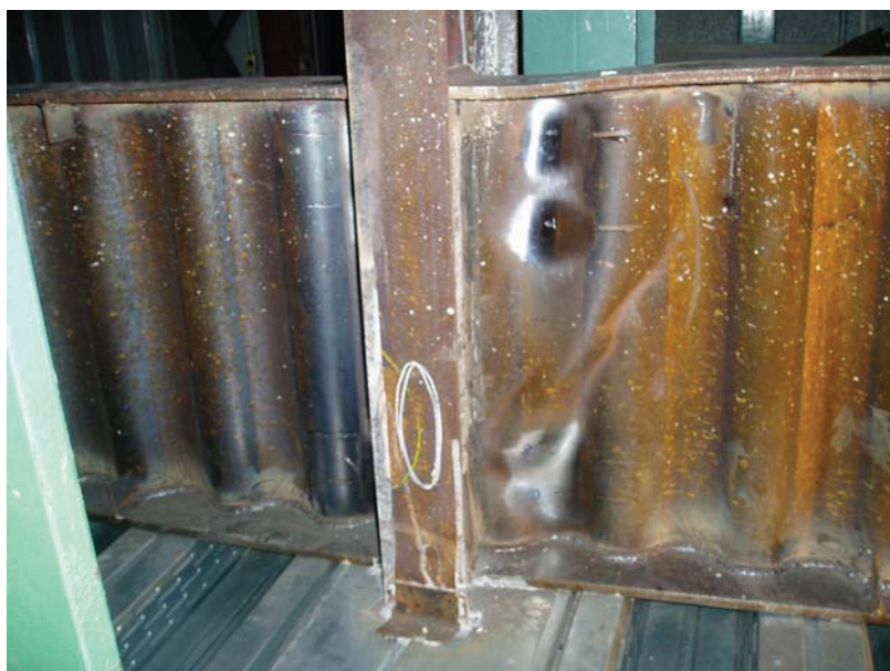
FIGURA 3.16 – Deformação da mesa e da alma na região da ligação no final do ensaio (Protótipo 2)
