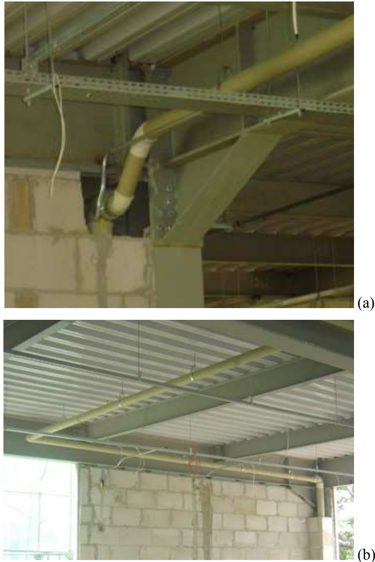
Figura 5.26. Tubulação de escoamento de água pluvial do terraço sendo direcionada para (a) shafts e (b) dutos principais de escoamento. (Fonte: arquivo pessoal. Fotos obtidas em 09/01/07).
