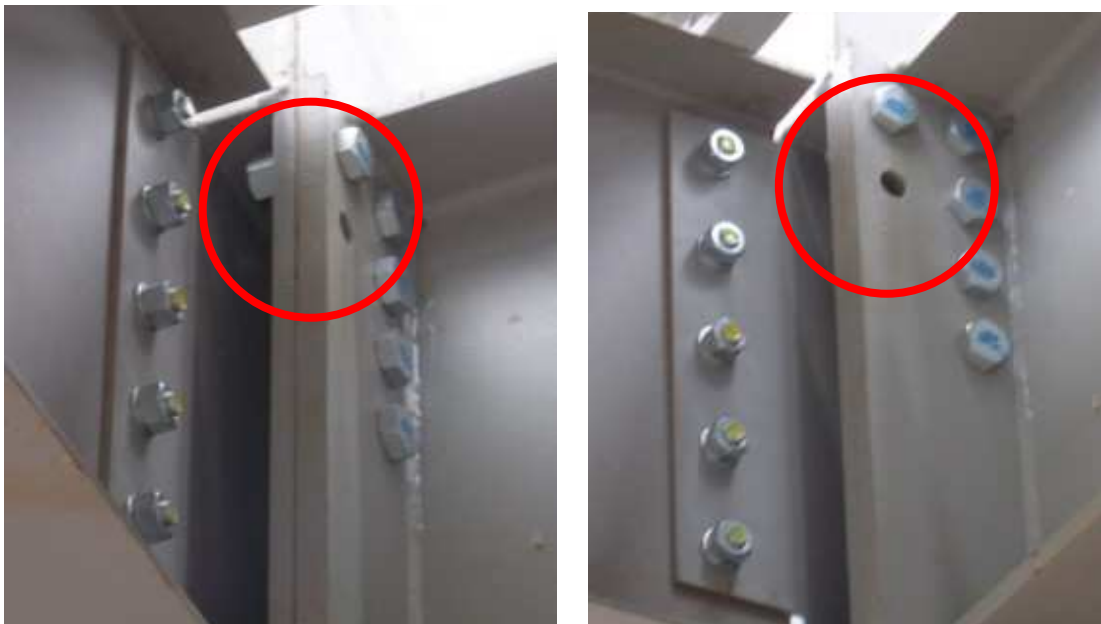
Figura 5.16. Erro na furação do pilar na ligação viga-pilar. (Fonte: arquivo pessoal. Fotos obtidas em 26/09/06)
