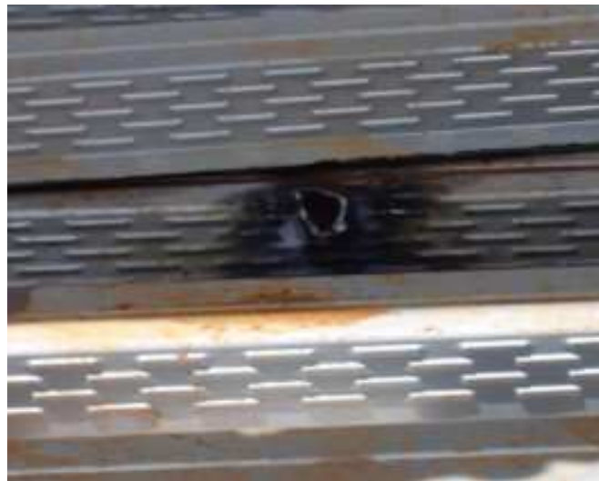
Figura 5.39. Chapa do steel deck danificada (Fonte: arquivo pessoal. Foto obtida em 26/09/06).
