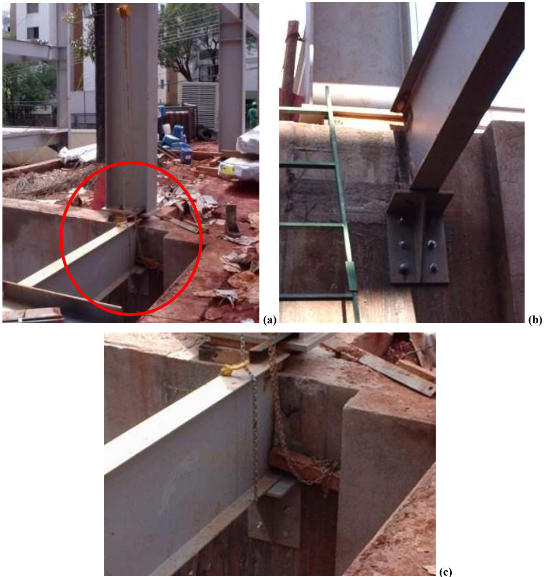
Figura 5.45. Viga seccionada no canteiro de obra (Fonte: arquivo pessoal. Fotos obtidas em (a) 25/09/06, (b) 26/09/06 e (c) 06/10/06).
