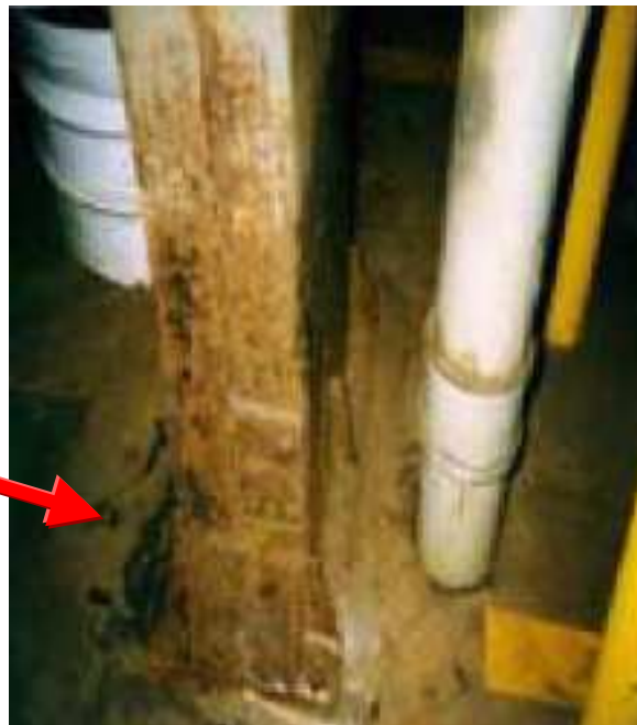
Figura 3.13. Corrosão uniforme proveniente de falha no processo de projeto (CASTRO, 1999)
