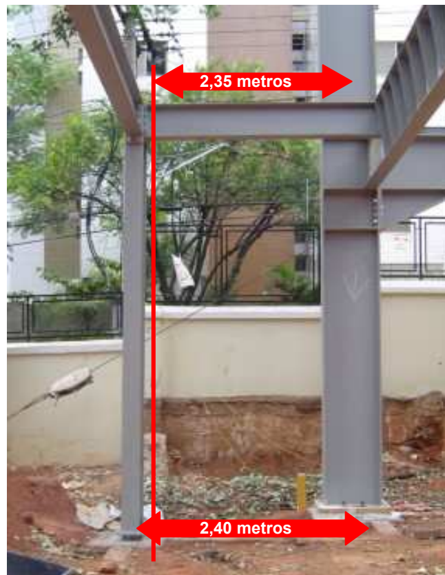
Figura 5.42. Desalinhamento dos pilares. (Fonte: arquivo pessoal. Fotos obtidas em 19/09/06).
