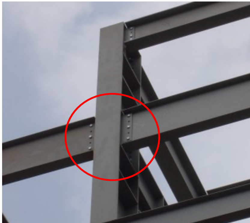
Figura 5.40. Erro na etapa de detalhamento do projeto estrutural. (Fonte: arquivo pessoal. Foto obtida em 19/09/06).
