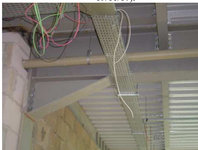
Figura 5.24. Posicionamento das instalações elétricas e hidráulicas aparentes sem interferência com a estrutura metálica. (Fonte: arquivo pessoal. Foto obtida em 09/01/07).
