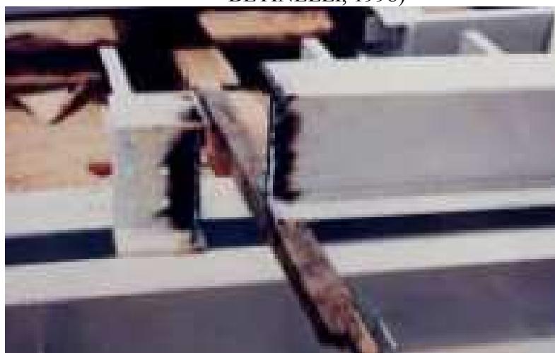
Figura 3.16. Comprimento excessivo da peça (PRAVIA & BETINELLI, 1998)
