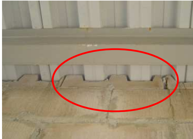
Figura 5.37. Encontro entre a alvenaria e a laje steel deck (Fonte: arquivo pessoal. Foto obtida em 09/01/06).
