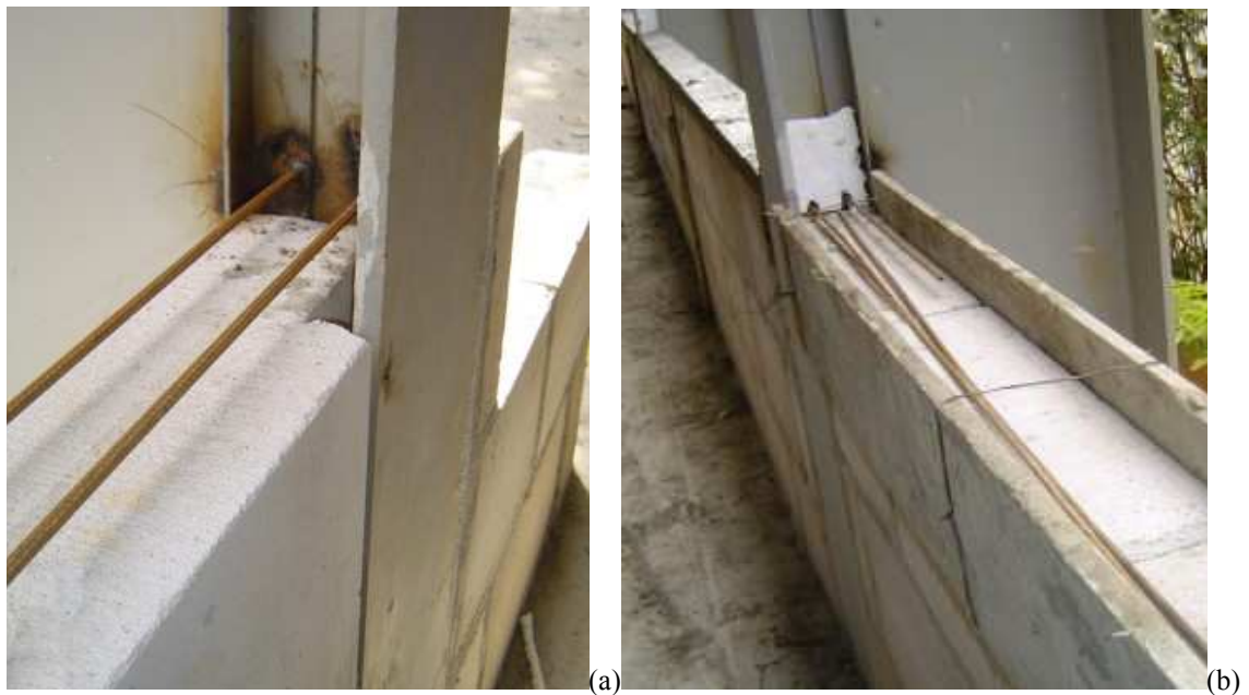
Figura 5.34. (a) Detalhe do ferro cabelo soldado ao pilar metálico e (b) Detalhe da chapa de isopor na interface entre alvenaria e estrutura metálica (Fonte: arquivo pessoal. Fotos obtidas em (a)24/10/06 e (b) 14/11/06).
