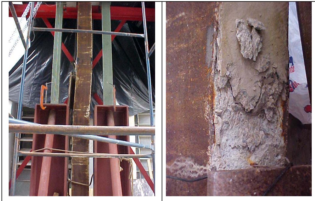
FIGURA 5.13.7 MAA-deformações permanentes no pilar e esmagamento do concreto.
