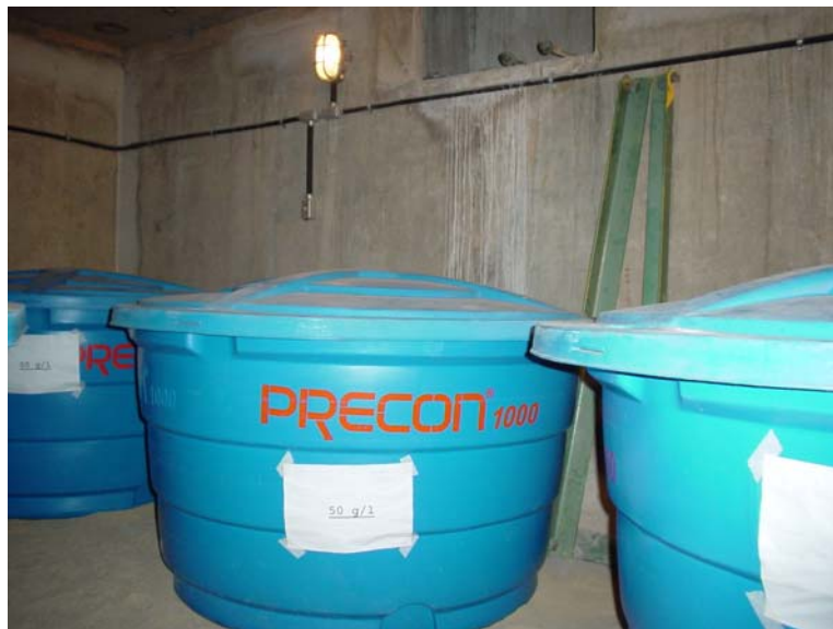
FOTO A.4: Caixas D'água de 1000 L.
