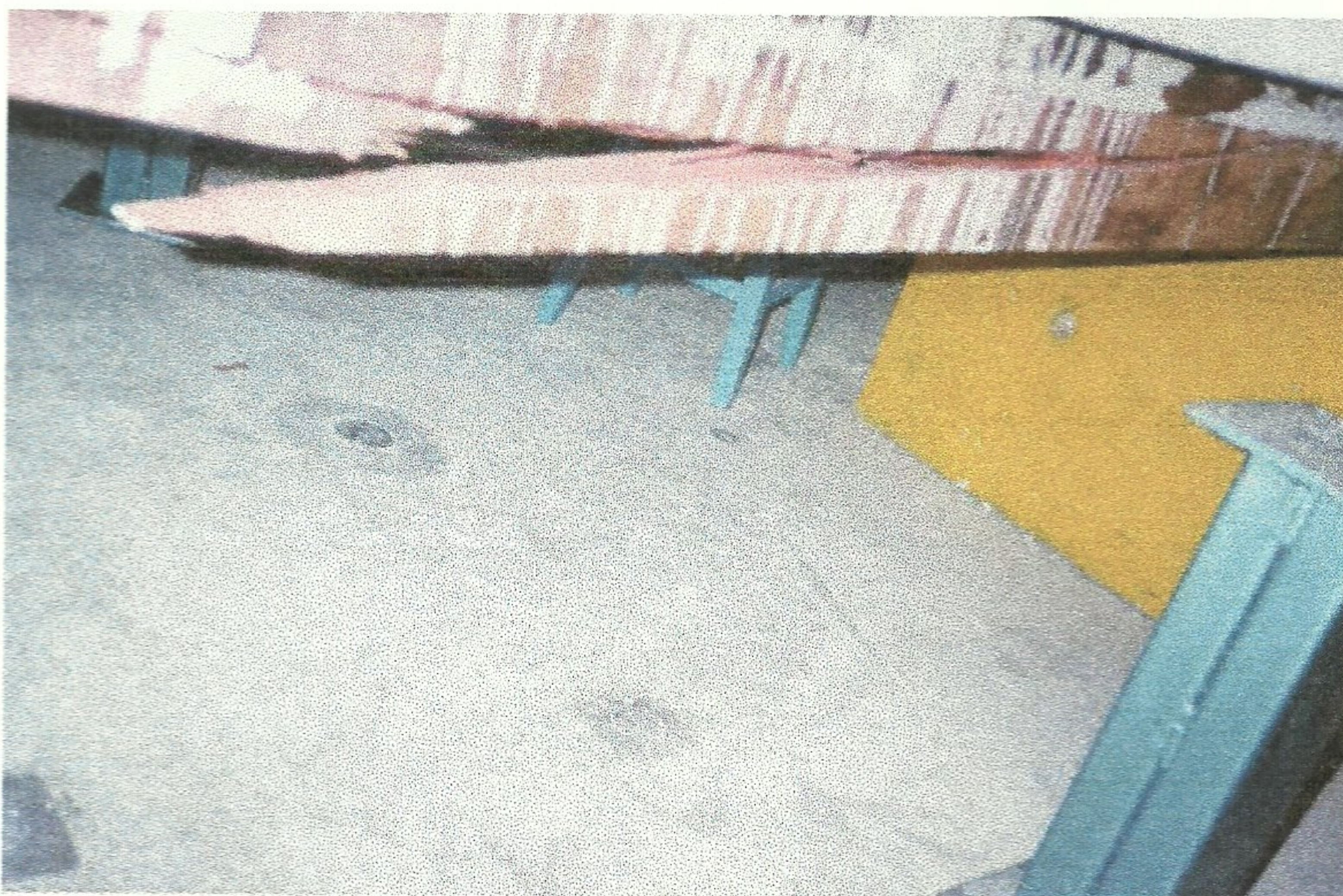
FOTO 10-Detalhe da Ruptura da Viga Composta
