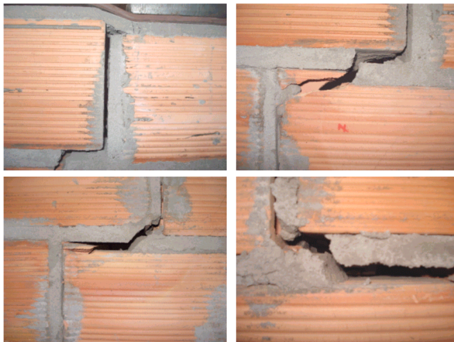
FIGURA 3.28 Detalhes da ruína da mini-parede 1 da Série 1.
