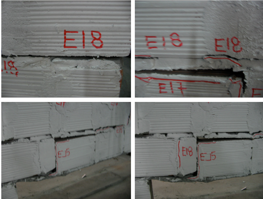
FIGURA 3.38 Detalhes do destacamento da argamassa e da espessura das juntas.
