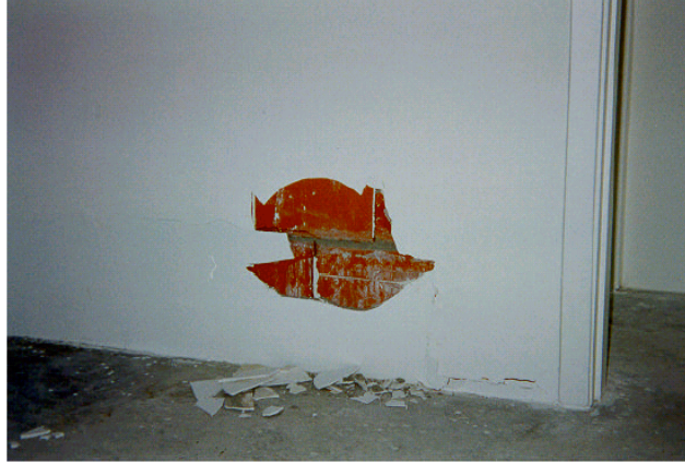
FIGURA 2.3 Detalhe de ruptura das fiadas inferiores de uma parede de vedação que denota o surgimento do efeito arco (MEDEIROS, 1999).
