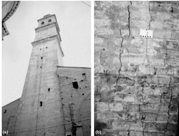
FIGURA 2.27 Vista da torre de St. Giustina (Pádua, Itália) e configuração das fissuras – Valluzzi et al. (2004)
