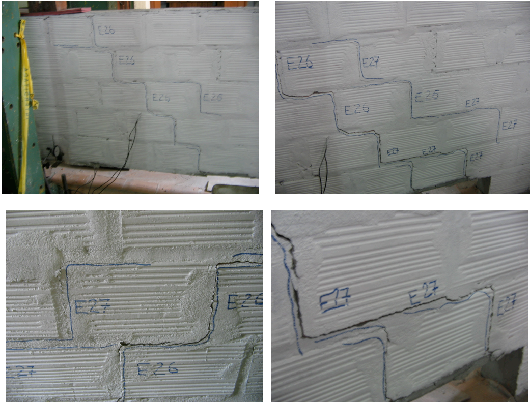
FIGURA 3.35 Modo de ruptura e detalhes das fissuras das mini-paredes da Série 2.
