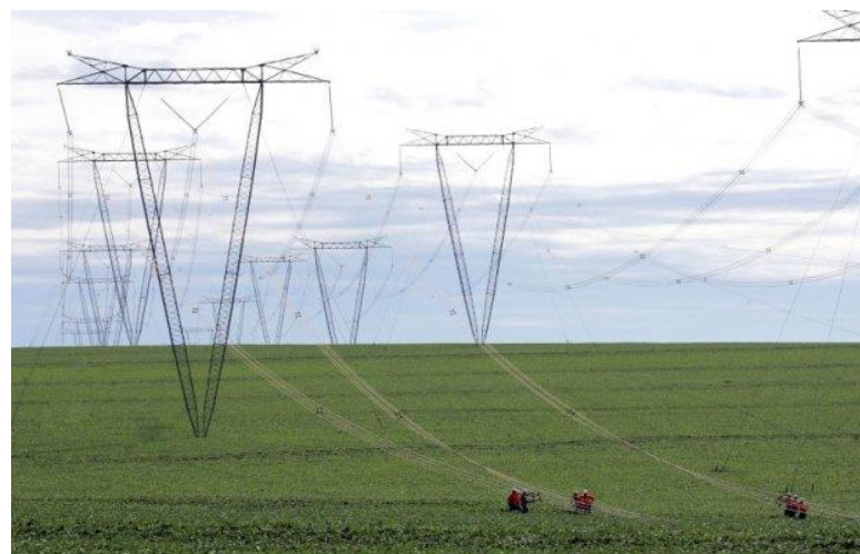
Figura 2.4 – Linha de transmissão no oeste do Paraná
