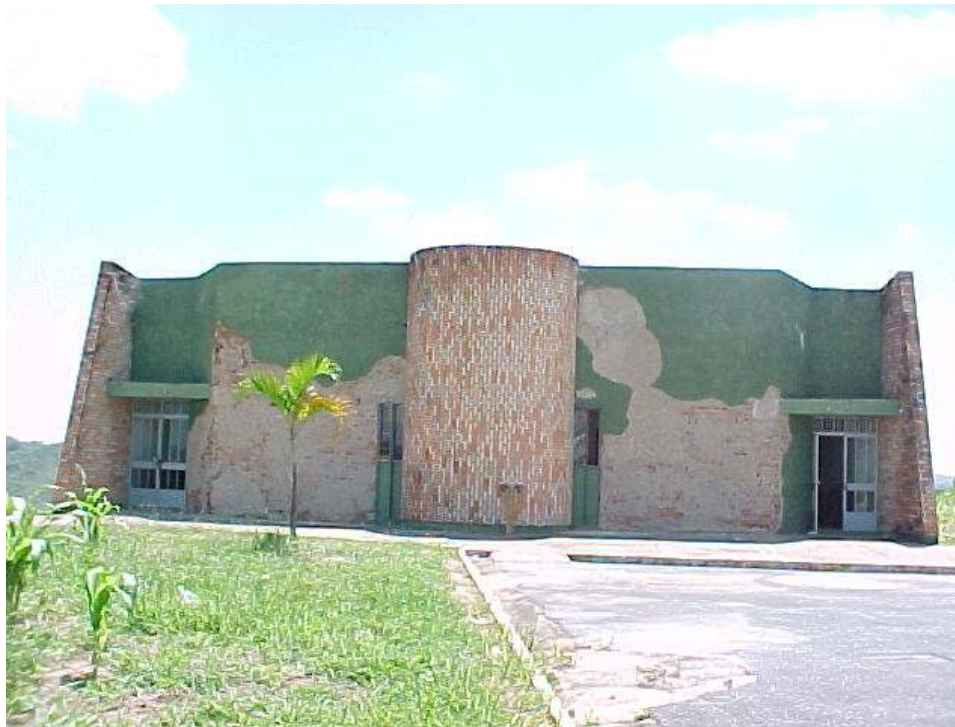
FIGURA 60 – Penitenciária Nelson Hungria. Vista do auditório. Foto anterior à reforma. Atualmente, o auditório está fora de uso.
