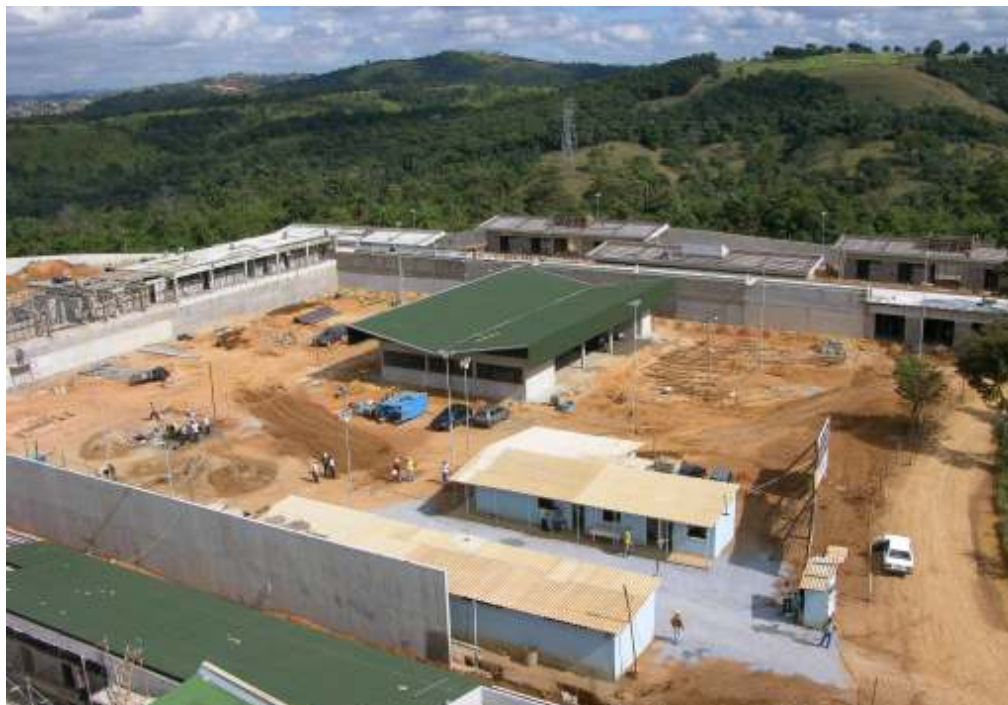
FIGURA 101 – APAC Santa Luzia. Foto da obra, tendo o prédio de apoio à família ao centro. As delimitações da praça são o prédio de apoio ao regime semi-aberto – que formam um “L” – na parte superior da foto, e o muro, em primeiro plano à esquerda.
