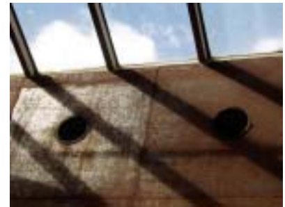
Figura 6.46 – Detalhe da solução de exaustão do ar do vazio central. Fonte: foto do autor, 2004.
