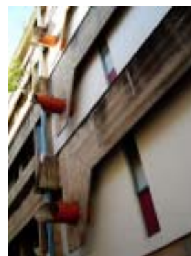
Figura 4.33 – Detalhe dos dutos de ventilação do Condomínio Tinguá Fonte: foto do autor, 2004.
