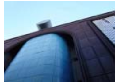
Figura 6.60 - Reservatório superior. Fonte: foto do autor, 2004.
