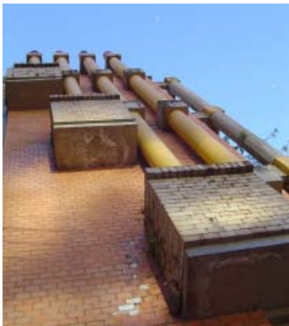
Figura 4.1 – Condomínio Barca do Sol: detalhe dos dutos de exaustão das lareiras. Fonte: foto do autor, 2004.
