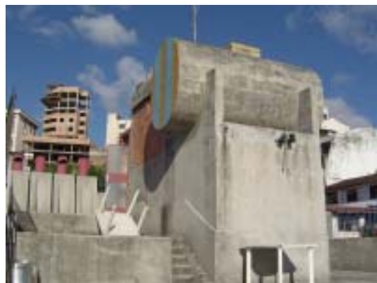
Figura 4.29 – Volume reservatório superior. Fonte: foto do autor, 2004.
