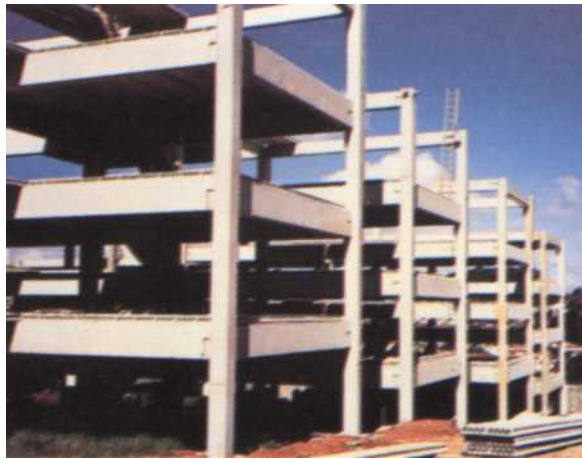
FIGURA 1- Estrutura composta por vigas e pilares em concreto pré-moldado, montada no local.
