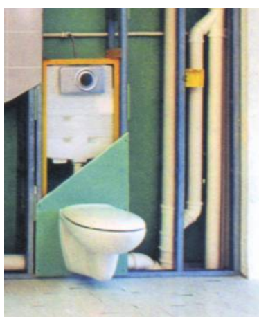
FIGURA 17- Louça sanitária fixada na parede, onde corre também o esgoto secundário. FONTE- Catálogo “Caixa de Descarga Front-BS”, fabricante Montana.
