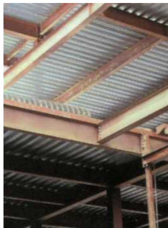
FIGURA 2- Estrutura composta por vigas e pilares em aço e lajes tipo steel deck , em que a forma da laje, em aço, recebe o concreto e participa do sistema portante.
