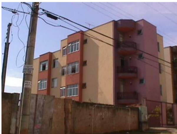
FIGURA 40- Edifício sem coroamento.
