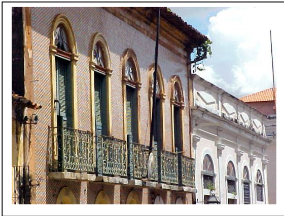
FIGURA 7.20: Sobrados à Rua 14 de Julho : Mudar sua estrutura interna para garantir economicamente a sua preservação ou deixar ruir? (São Luiz, Maranhão, Foto: E. Abrahão, fonte: www.patrimonioslz.com.br )
