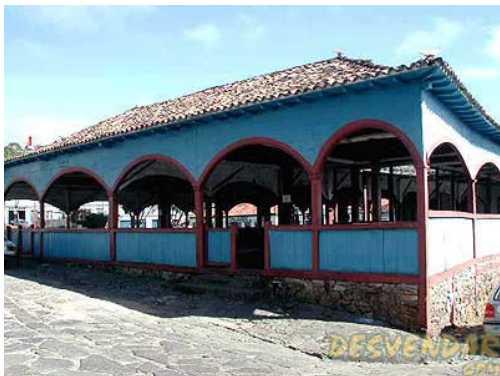
FIGURA 6.9: Mercado de Diamantina: o uso de vidro temperado nas esquadrias de madeira perdidas, longe de conferir uma neutralidade à interferência, acaba criando uma “estranheza” visual. (Fonte: Prefeitura de Diamantina)
