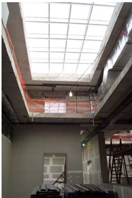
FIGURA 105 - Clarabóia da sala de exposição do 4º pavimento (25/06/07). Fonte: Arquivo particular da autora.
