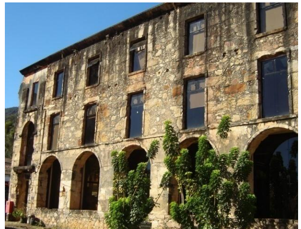
FIGURA 62 – [Fachada oeste com sua aparência externa mantida, inclusive com os sinais do incêndio]
