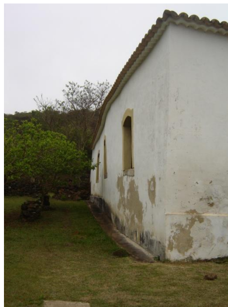
FIGURA 80 – [Sede da fazenda São José do Manso, Ouro Preto: vista do perfil de uma das fachadas com sinais da consequência da desestabilização]
