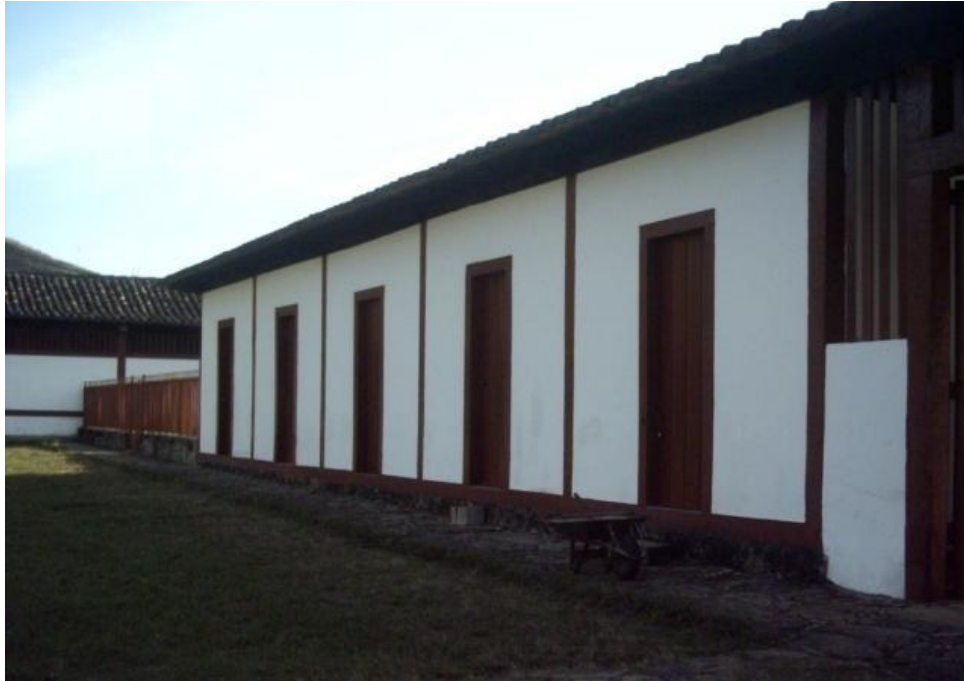
FIGURA 33 – [Não-distinção entre os trechos reconstruídos (interferência contemporânea, principalmente estrutural) e os trechos apenas consolidados]
