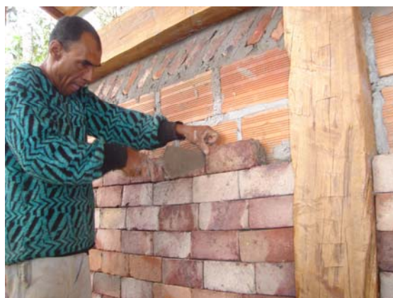
FIGURA 73 Pousada- casa principal: esquema construtivo das paredes de vedação Fonte: Imagem cedida pelo arquiteto em setembro 2008
