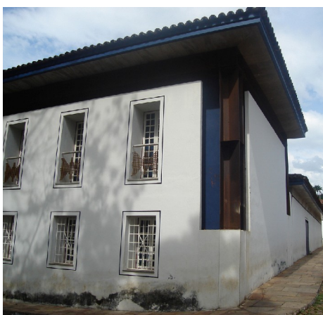
FIGURA 104 - Foto atual da casa, com o acrécimo em alvenaria na base do pilar metálico, que foi construído pela arquidiocese aleatoriamente à opinião dos arquitetos.
