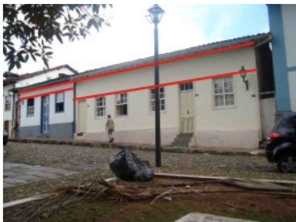
FIGURA 116 - Edificação 01, alinhamento de janelas com verga maior que o padrão.
