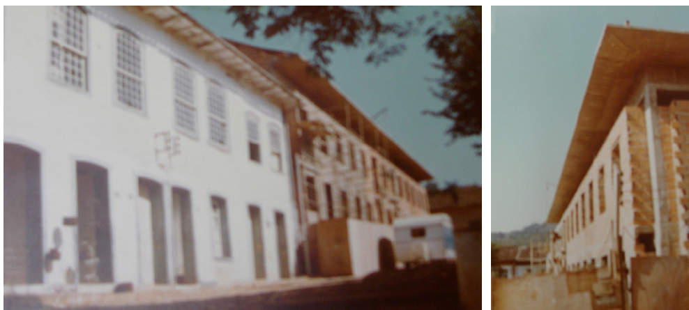
FIGURAS 100 e 101 - Fotos da obra na época do embargo, detalhe para o desnível em relação à edificação vizinha.
