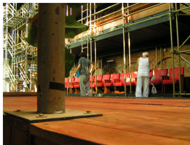
FIGURA 165 – Vista da rua interna a partir do cômodo no subsolo. Fonte: Foto do autor, 2009
