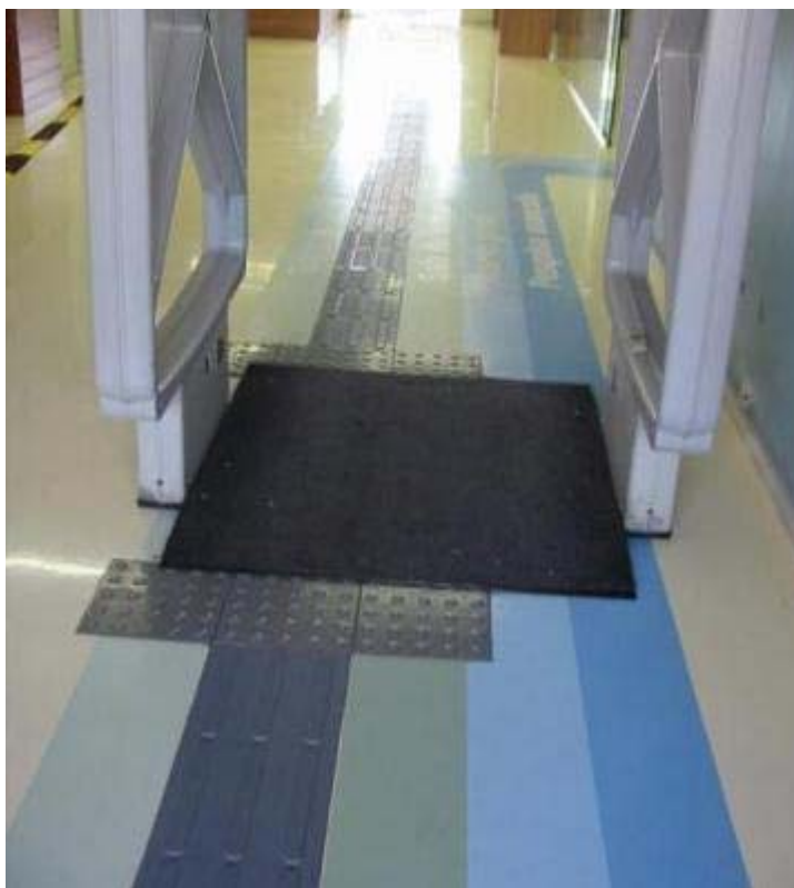
FIGURA 45- Piso tátil da biblioteca da ECI Fonte: GUIMARÃES, GRENFELL e PICCELI, 2007-09.
