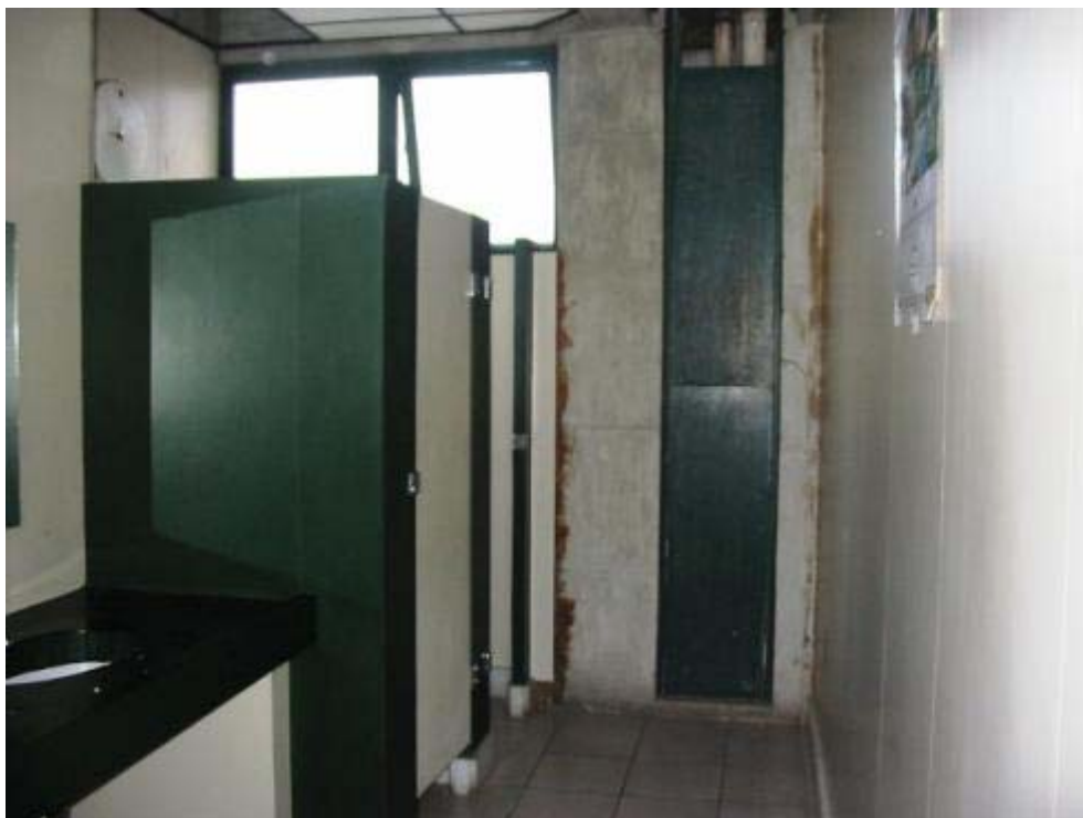
FIGURA 79 - Sanitário coletivo feminino no quarto pavimento da FAFICH Fonte: GUIMARÃES, GRENFELL e PICCELI, 2007-09.
