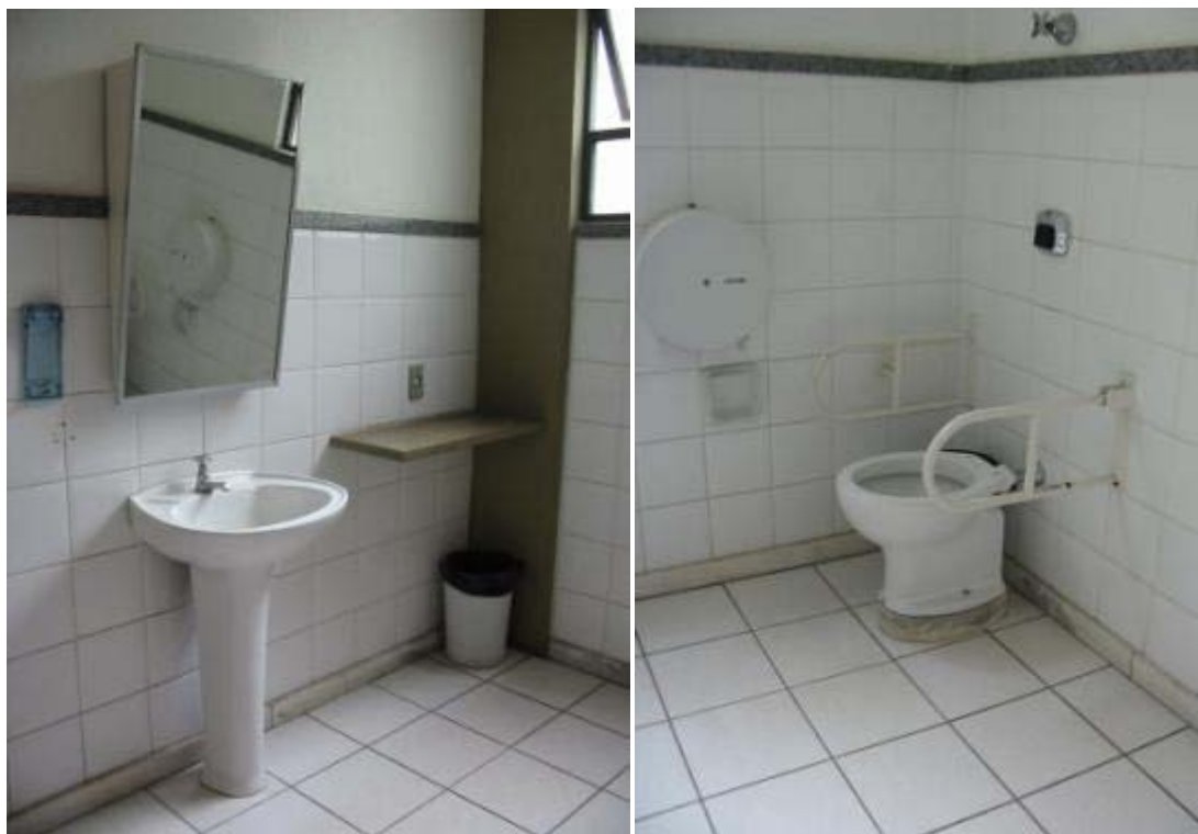
FIGURA 84 - Sanitário individual acessível – FAFICH Fonte: GUIMARÃES, GRENFELL e PICCELI, 2007-09
