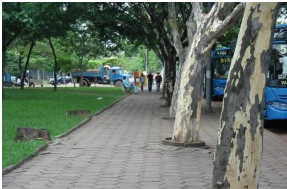
FIGURA 49 - Estado de conservação da calçada na Av. Reitor Mendes Pimentel Fonte: GUIMARÃES, GRENFELL e PICCELI, 2007-09
