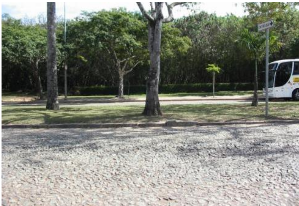
FIGURA 52 - Piso da pista de rolagem de veículos da Av. Reitor Mendes Pimentel Fonte: GUIMARÃES, GRENFELL e PICCELI, 2007-09.
