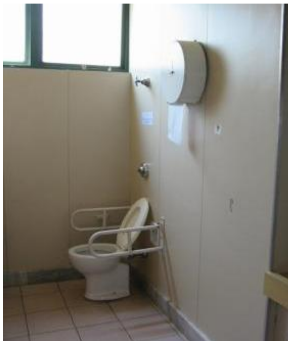
FIGURA 31 - Sanitário acessível unissex – FAFICH Fonte: GUIMARÃES, GRENFELL e PICCELI, 2007-09.
