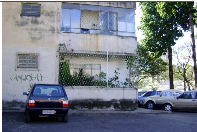
Figura 02 – Vandalismo e descaracterização das janelas da fachada
