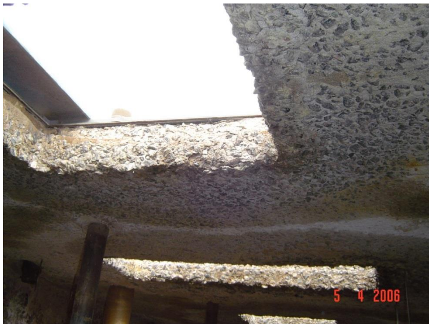
Figura 5.19 - Superfície inferior da laje de cobertura de um reator agredida por biogás, 2016.
