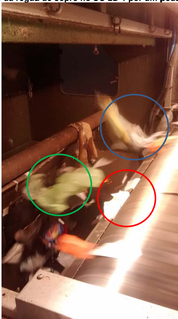
Figura 25 – Obstrução da régua de sopro no SO 2D-1 por um pedaço de papel
