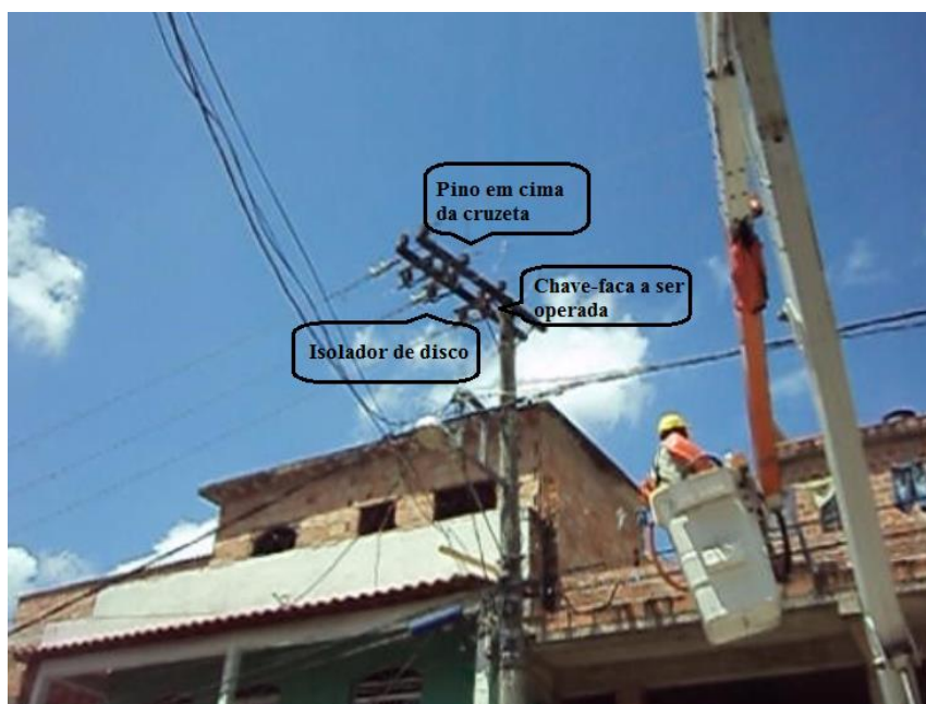
Figura 6 - Posição dos cabos na estrutura índice 2-3 e da chave-faca a ser operada.
