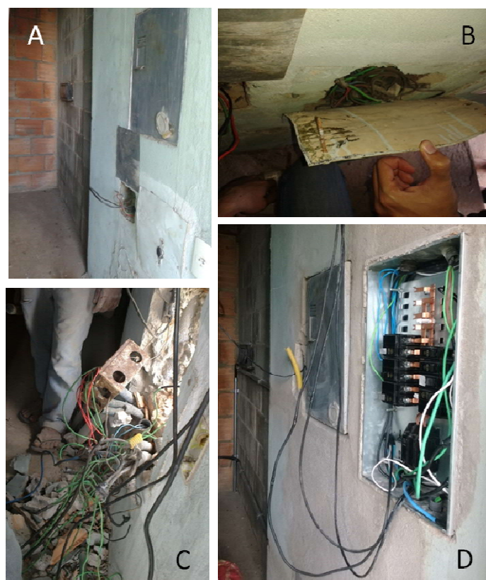
Figura 4-7 - Padrão de entrada – A e B: antes da reforma, C: durante a reforma e D: após a reforma e instalação do DSV e novo quadro de distribuição.
