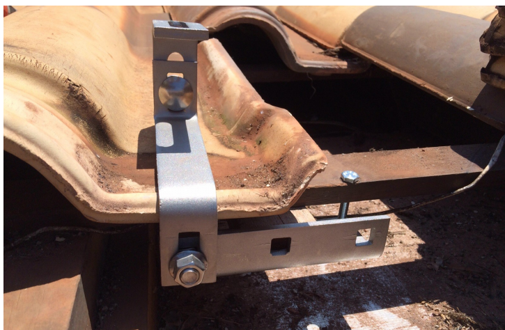
Figura 3-12 - Foto de suporte com capacidade de adaptação, (Fonte: acervo próprio).
