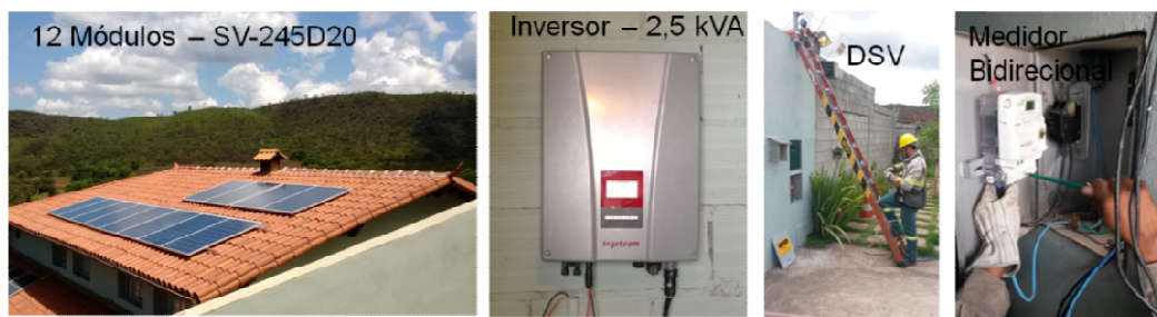
Figura 4-1- Equipamentos do sistema fotovoltaico.
