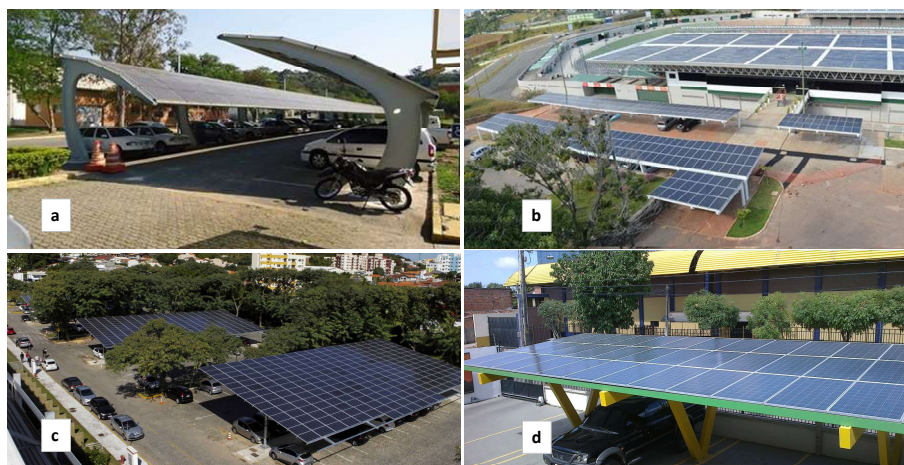
Figura 3-4 - Exemplos de estacionamentos fotovoltaicos instalados no Brasil. (a) USP, (b) Pituçu Solar, (c) Megawatt Solar e (d) Kwara do Brasil.
