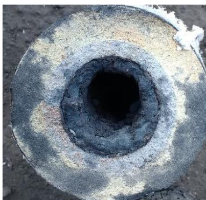
Figura 3.11 - Válvula submersa com incrustação de óxidos.
