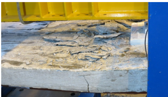
(a) ruptura da laje (vista anterior)
