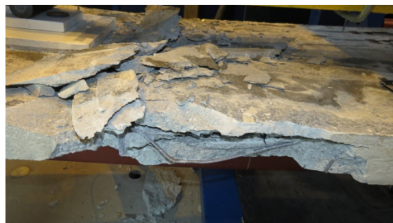
(d) deslocamento do concreto (vista posterior)
