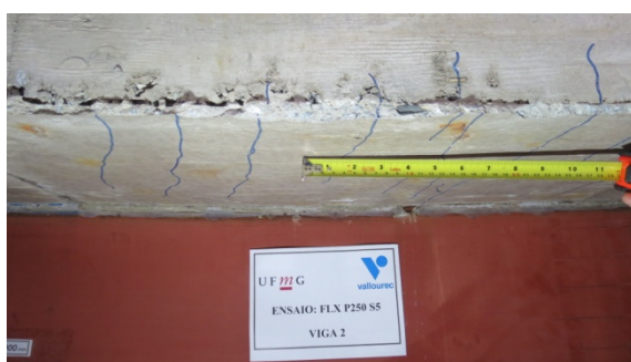
(d) fissuras na região entre L_0/3 e L_0/2 (vista anterior)
