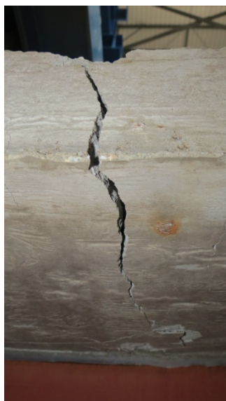
(a) fissura principal (vista anterior #1)
