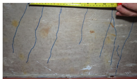
(e) fissuras na região entre L_0/3 e L_0/2 (vista anterior)
