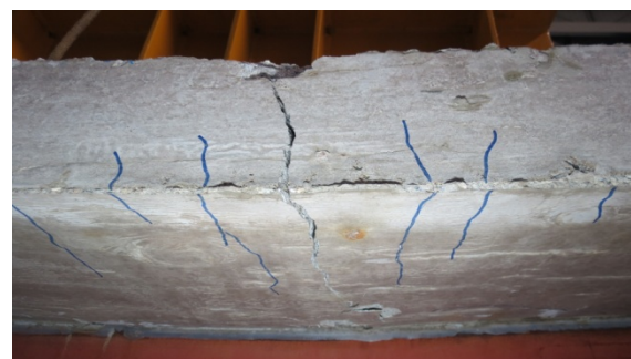
(b) fissura principal (vista anterior #2)
