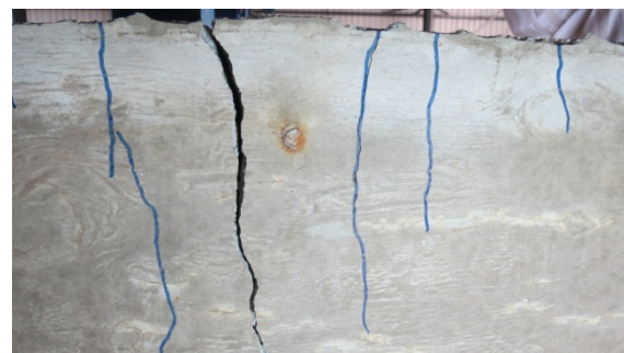
(c) fissura principal (vista anterior #3)
