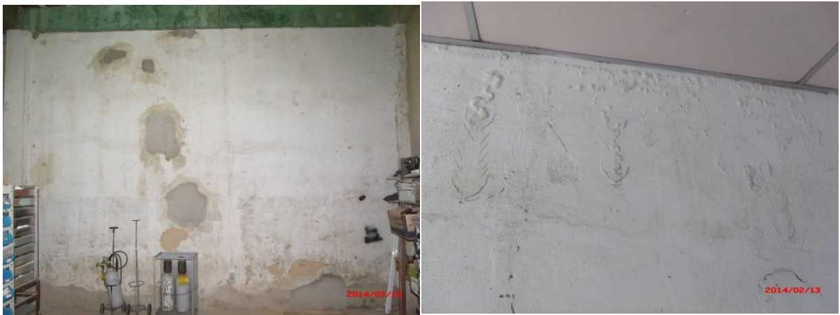
Figura 4.1832 - Presença de umidade em algumas paredes localizada entre as edificações.
