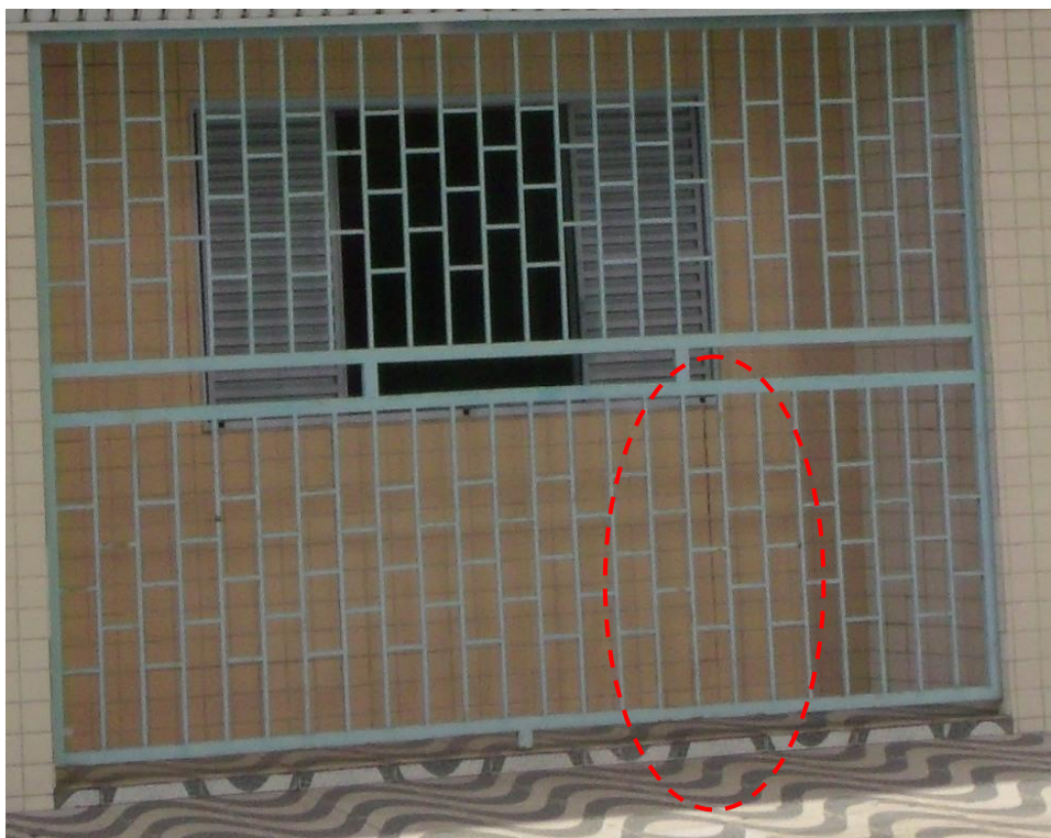
Figura 4.5 - Fachada da edificação posterior a construção da edificação vizinha.
