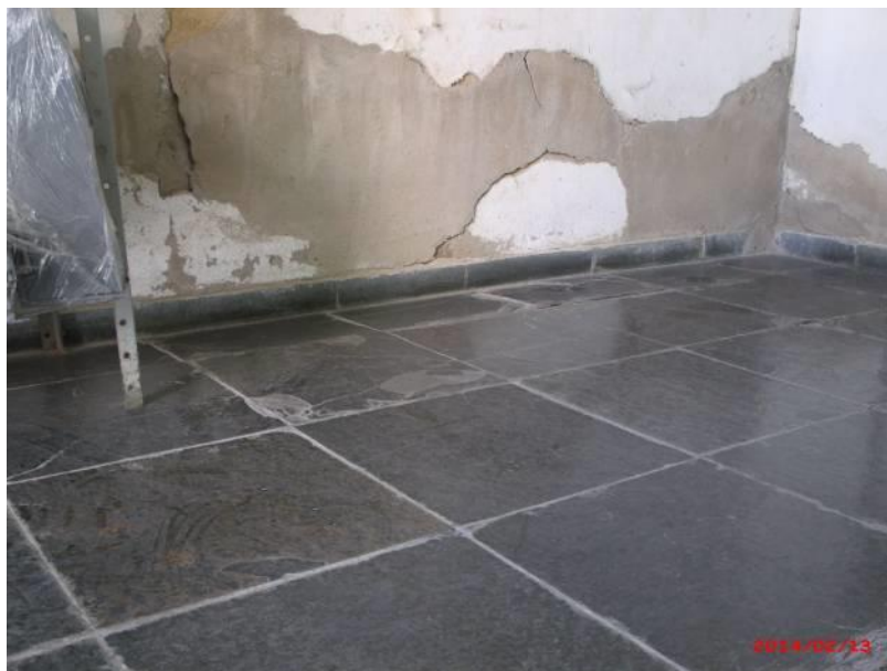
Figura 4.1327 - Desnível do piso da recepção.
