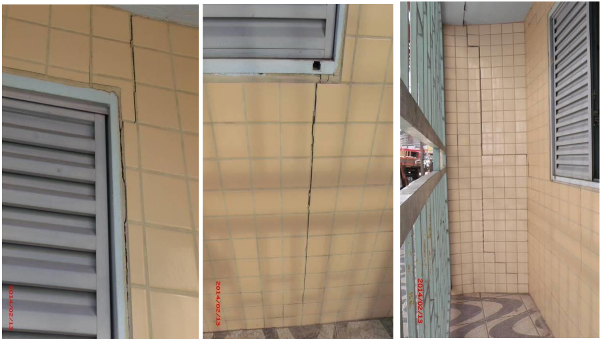
Figura 4.2 - Trincas e rachaduras na fachada da edificação.
