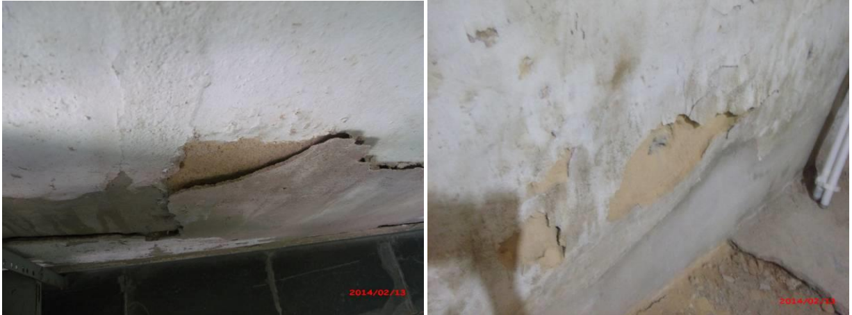
Figura 4.19 - Presença de desprendimento de reboco em algumas paredes localizada entre as edificações.
