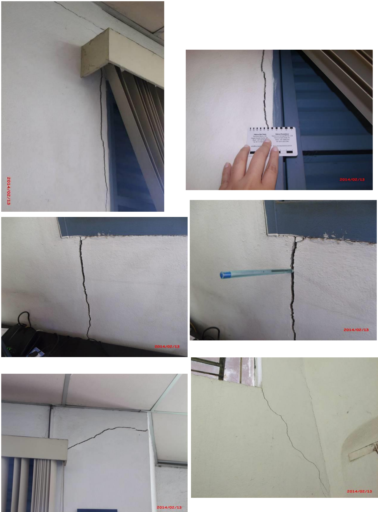
Figura 4.1125 - Rachaduras próximo ao vão de janelas na diagonal - medição da espessura com fissurômetro.
