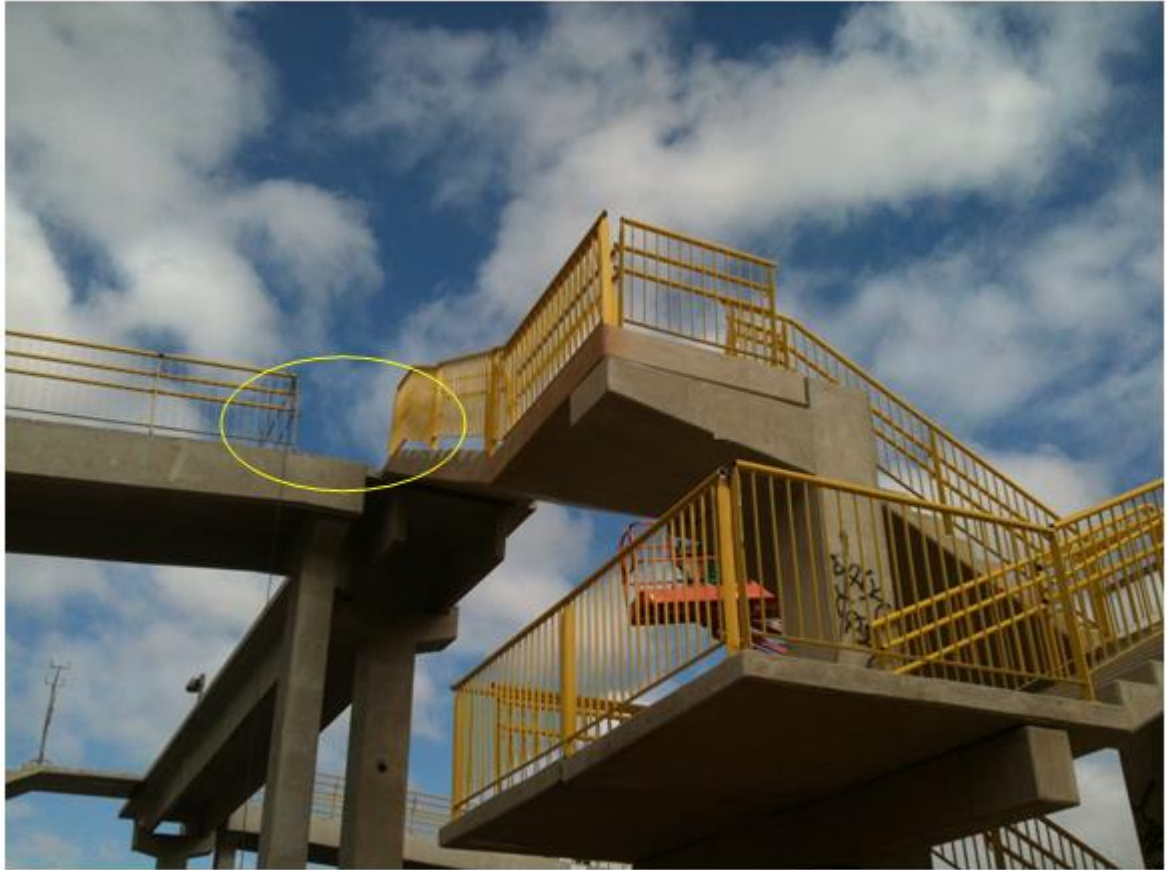
Figura 22 – Falta de peças de guarda-corpo incompatibilidade de projeto.
