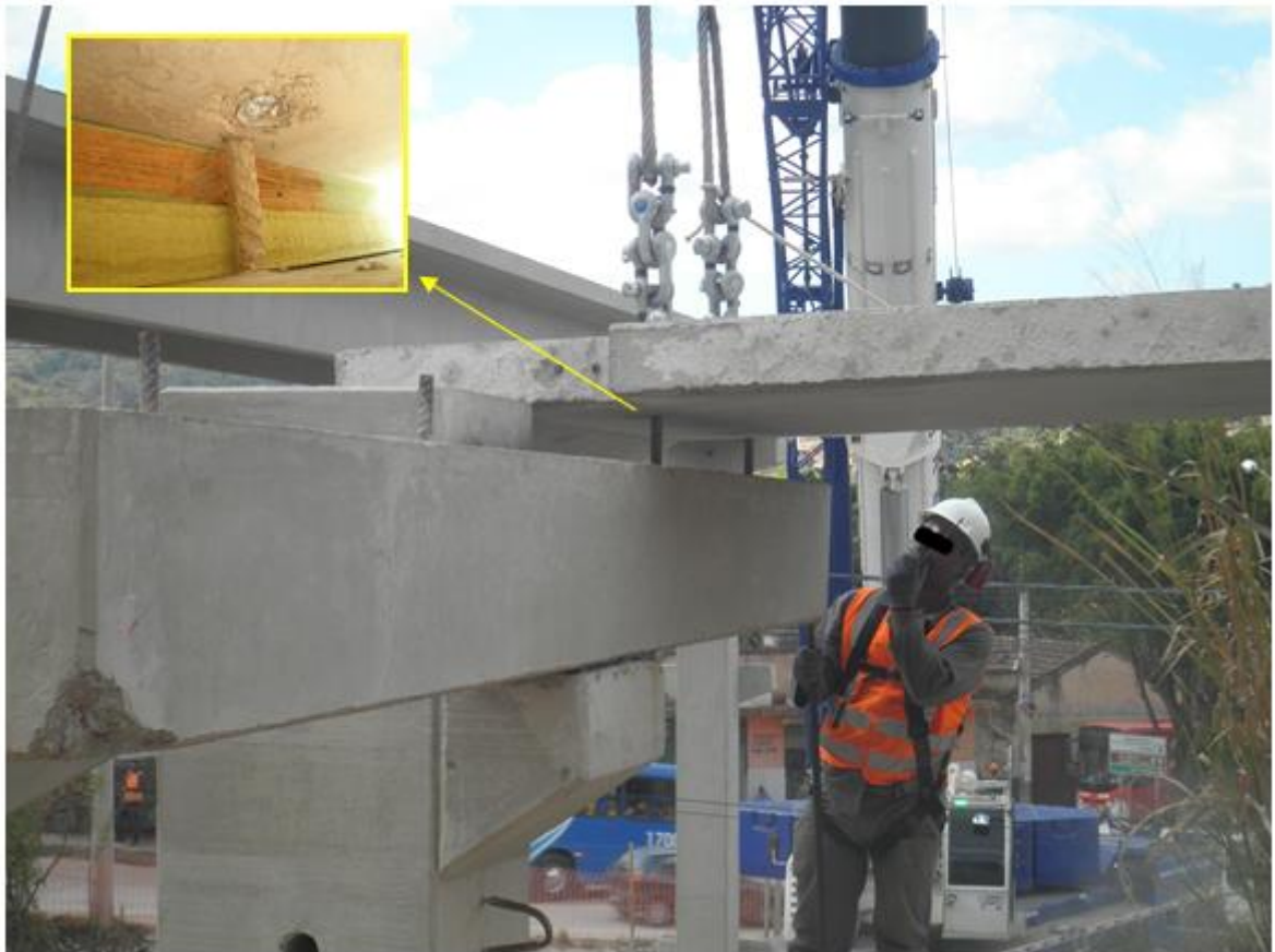
Figura 26 – Falha no encaixe das peças pré-moldadas na base de apoio.
