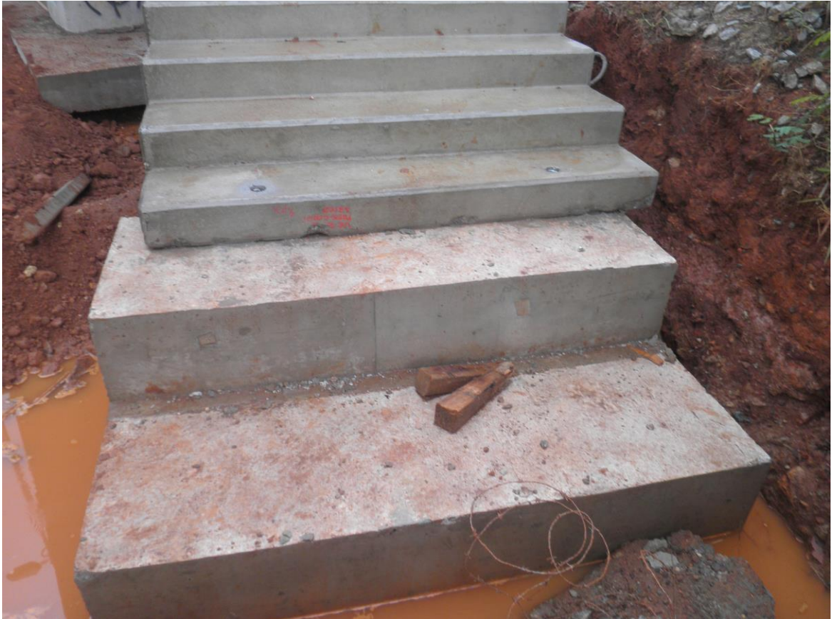
Figura 20 – Encaixe fora de alinhamento entre a fundação (base de apoio) com a peça pré-moldada de escada.
