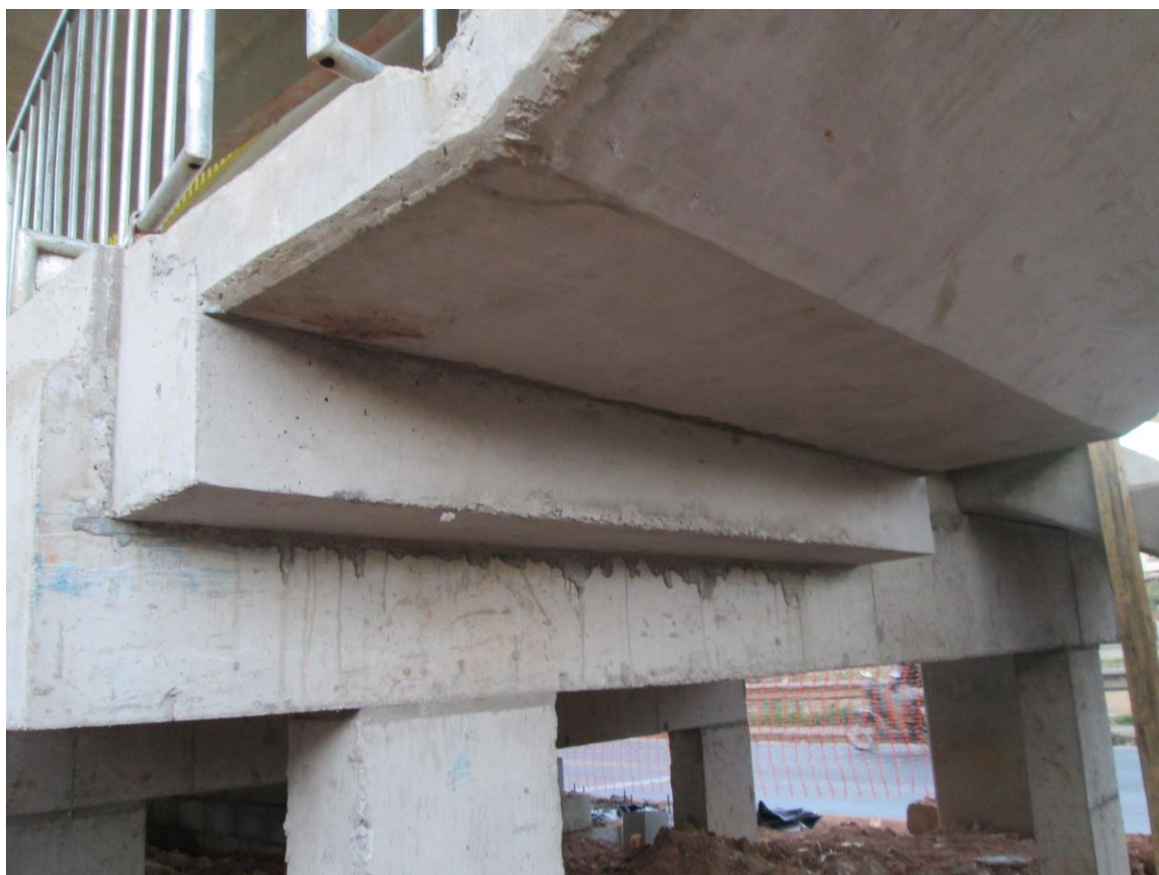
Figura 27 – Retrabalho na execução de uma viga de apoio para a peça pré-moldada.
