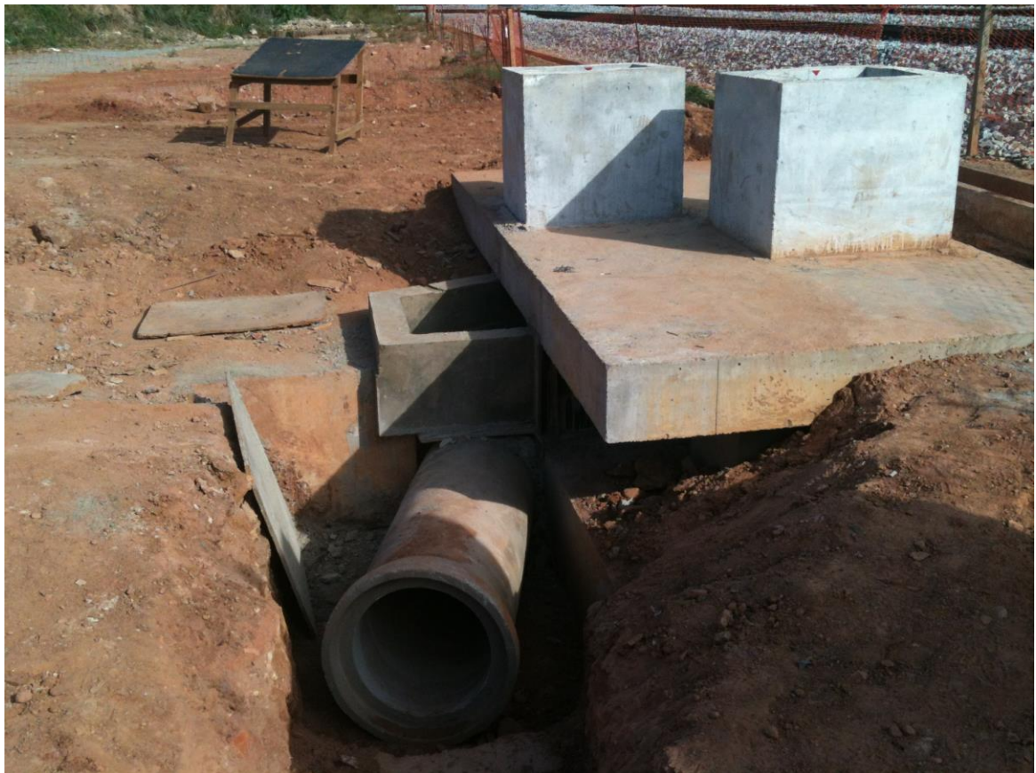
Figura 18 – Laje construída para sobrepor a tubulação de drenagem pluvial que interferia com o bloco de fundação.
