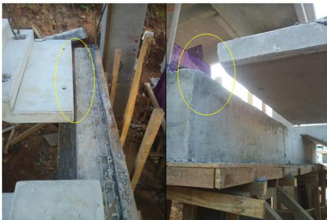
Figura 25 – Falha no encaixe das peças pré-moldadas na base de apoio.
