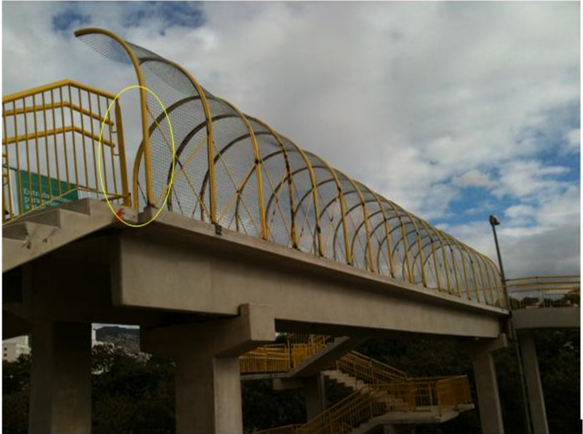
Figura 23 – Falha no projeto de guarda-corpo no encaixe da sequência de montagem.
