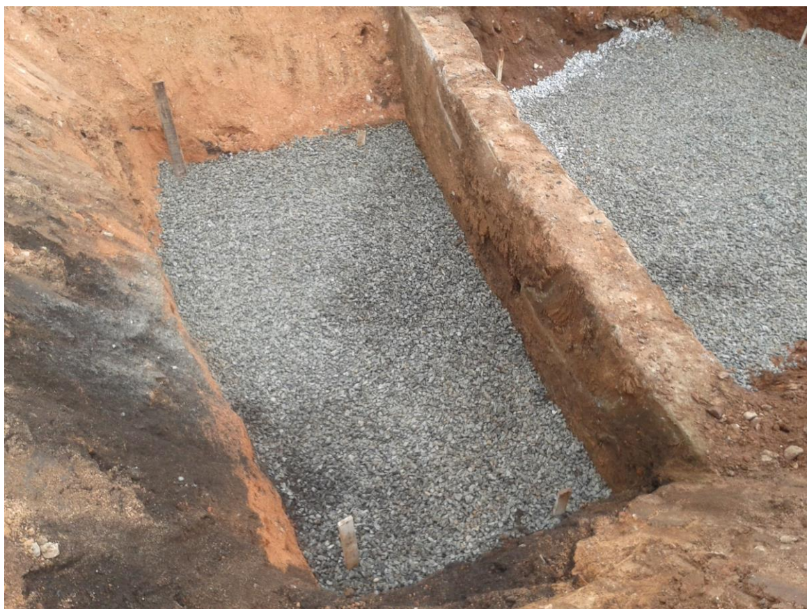
Figura 16 – Viga de concreto interferindo com o bloco de fundação.
