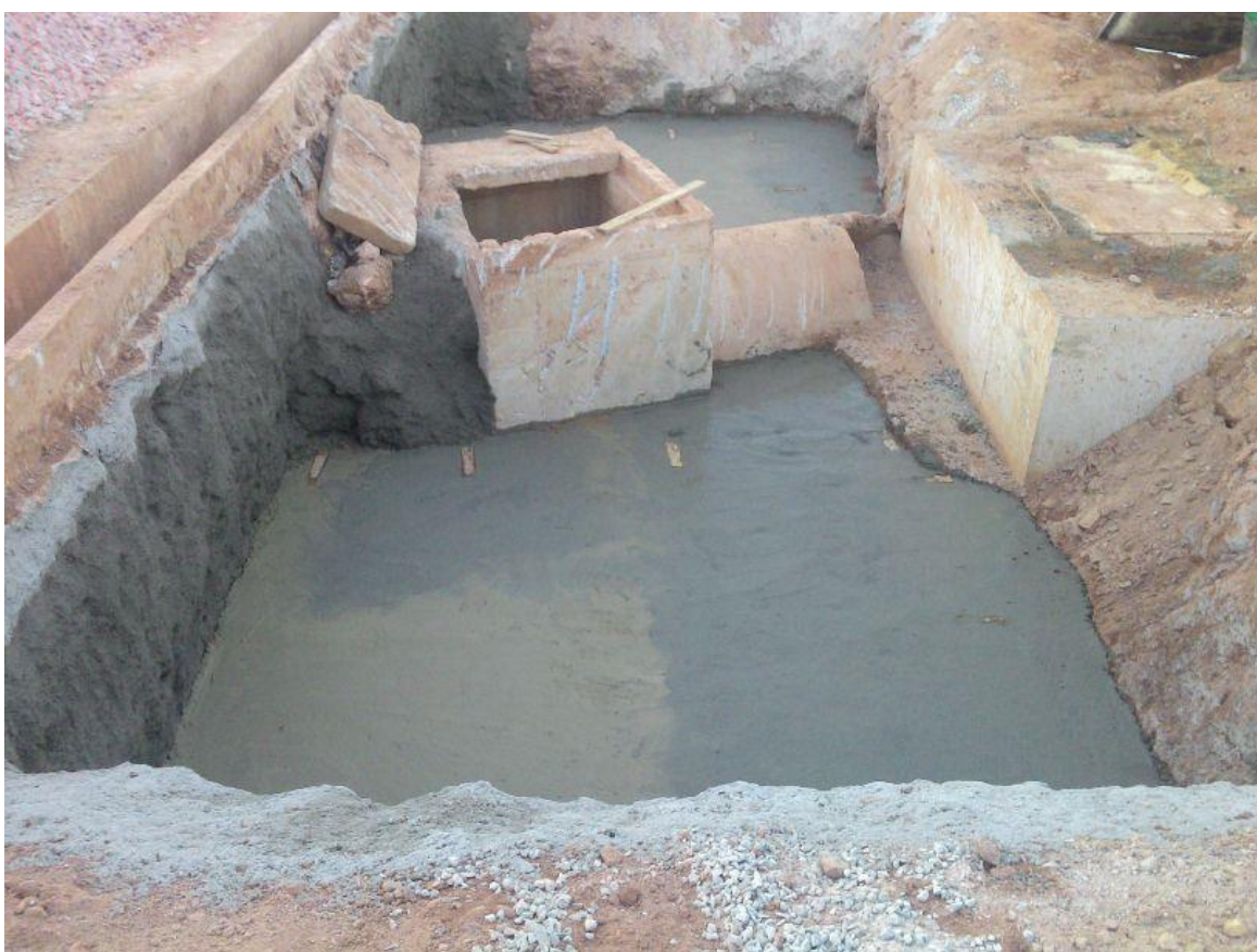
Figura 17 – Tubulação de drenagem pluvial interferindo no bloco de fundação.
