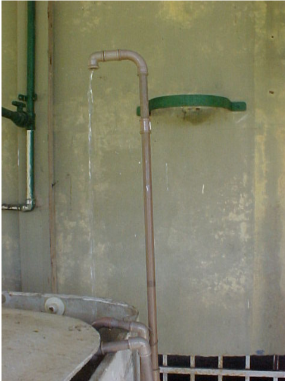
Figura 4.14: Tubulação de saída de água filtrada
