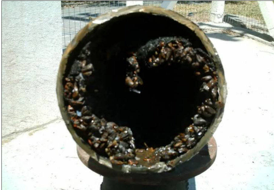
Figura 5.27: Detalhe de adutora sob efeito de macrofouling pelo L. fortunei .
