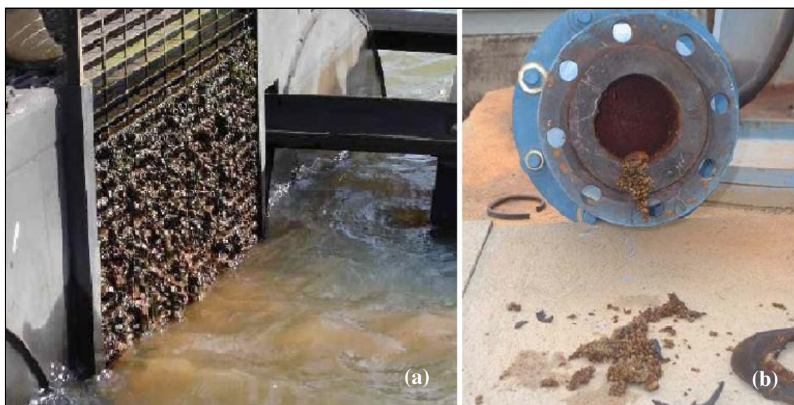
FIGURA 3.2 : (a) Grade de captação flutuante da SANEPAR no lago de Itaipu. (b) Detalhe de limpeza de registro obstruído.
