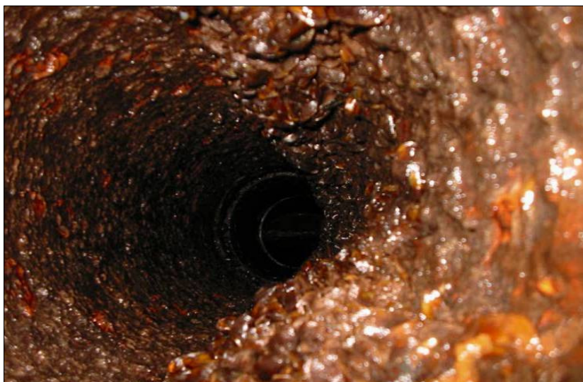
Figura 5.26: Vista do interior de adutora infestada pelo L. fortunei .
