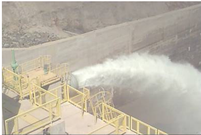
Figura A11: Válvula de abertura manual
