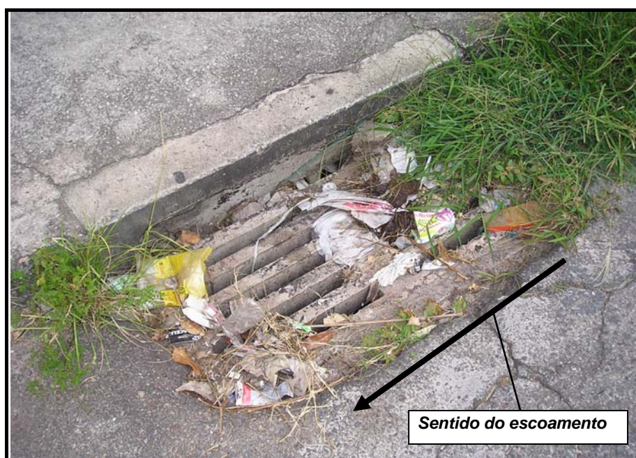
Figura 4.15 – Aspecto de obstrução da grelha por resíduos sólidos
