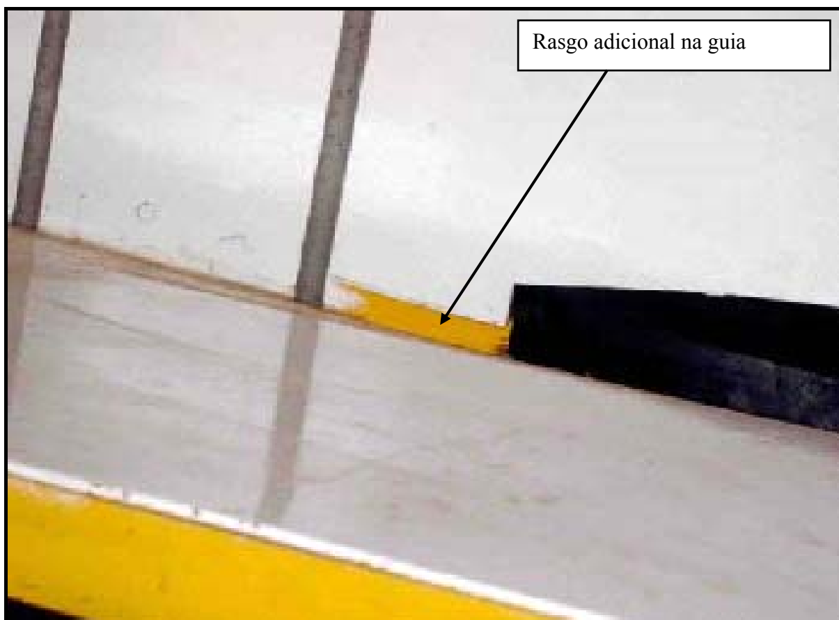
Figura 4.7 – Bocas-de-lobo com abertura e rasgo adicional na guia
