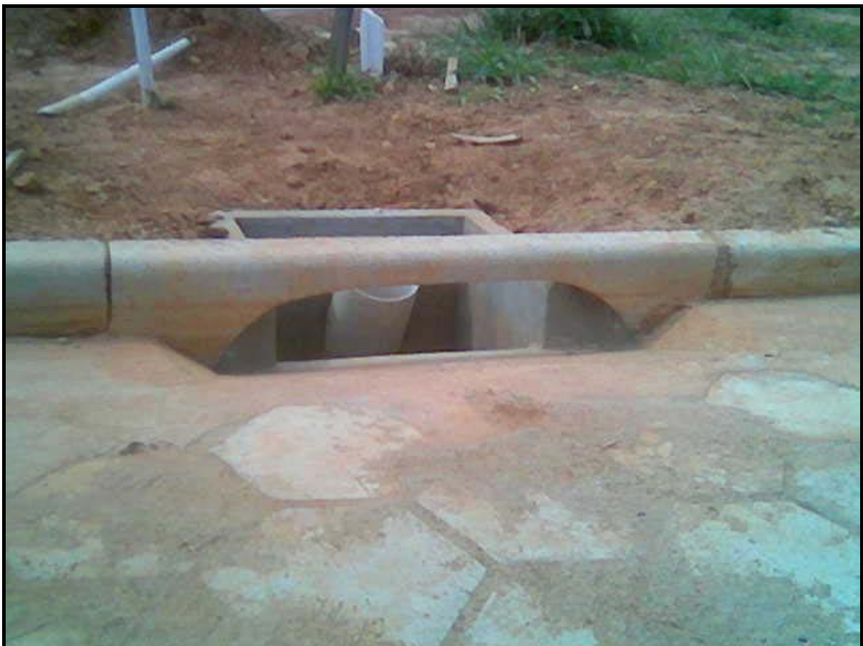
Figura 4.18 – Boca-de-lobo com caixa de retenção utilizada em Camanducaia, MG.
