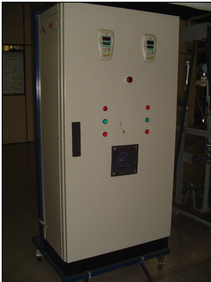
FIGURA 3.18- Painel de acionamento das bombas
