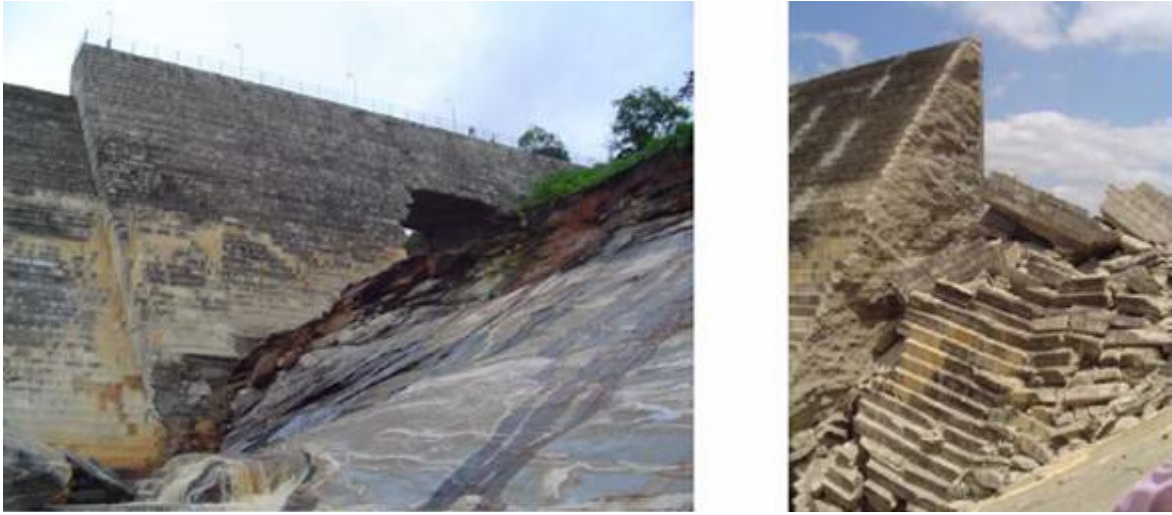
Figura 3.15 – Orifício que provocou o esvaziamento do reservatório e situação após 11 dias (BARBOSA et al. , 2004)
