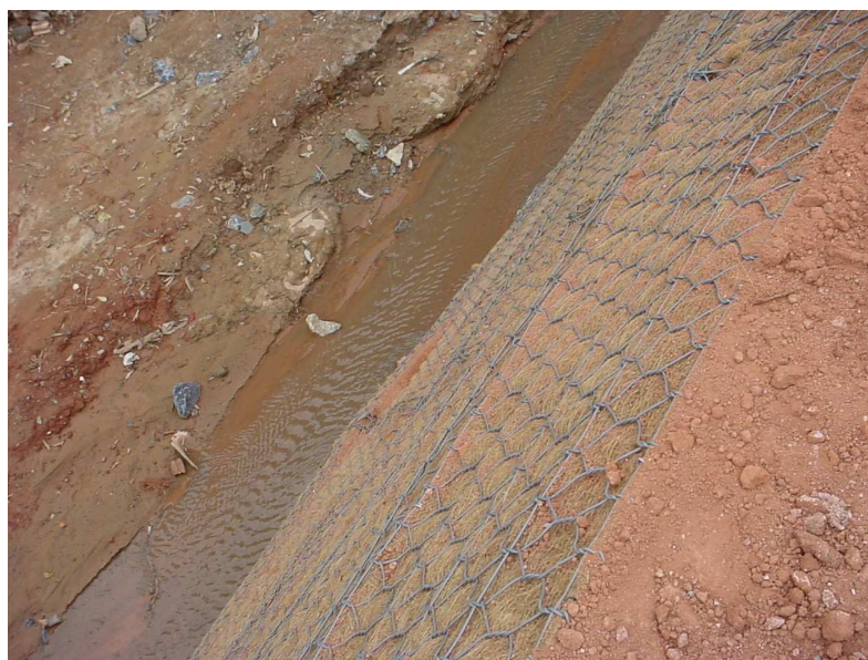
Figura 4.7 – Terramesh (tela vegetal) utilizada para a contenção de taludes no córrego Baleares - Belo Horizonte/ MG (Foto: Rodrigo França).
