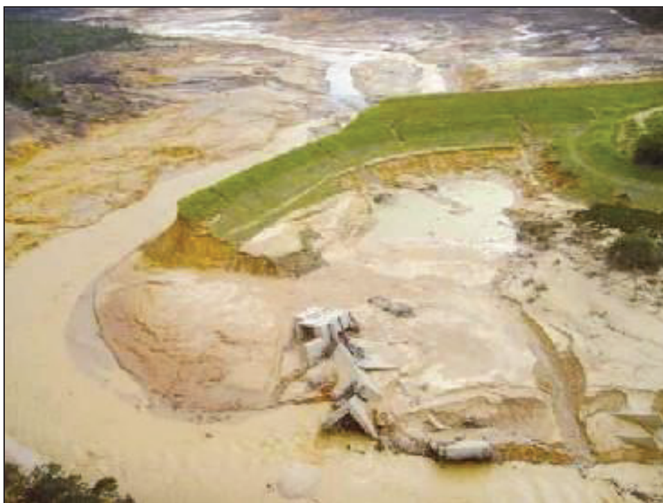
Figura 3.20 – Vista da área após a ruptura da PCH Apertadinho
