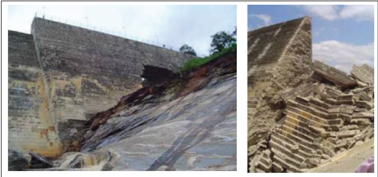
Figura 3.17 – Vista da barragem de Camará após a ruptura, com o orifício que provocou o esvaziamento do reservatório, e a situação após 11 dias
