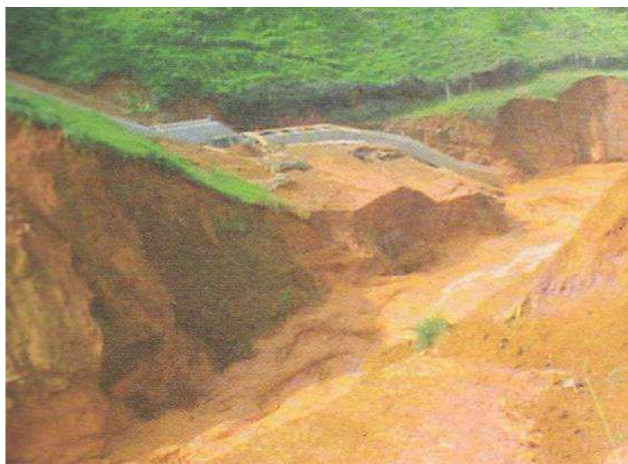
Figura 1.5: Brecha originada na ruptura da Barragem São Francisco.
