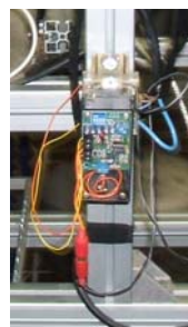
Figura 3.16 – Sistema de acionamento das lâmpadas
