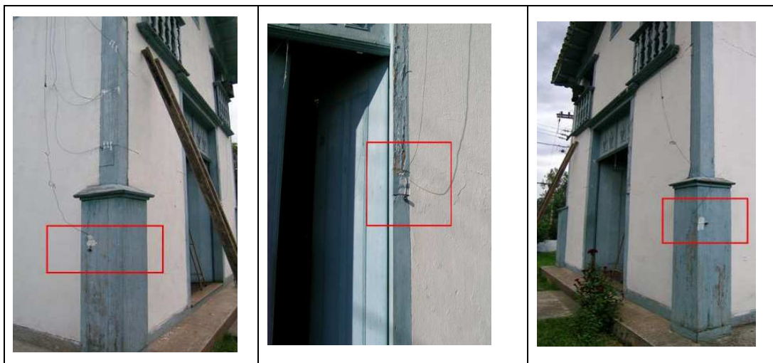
FIGURA 3.16 – Fotos da localização dos piranômetros. Fachada frontal da capela.
