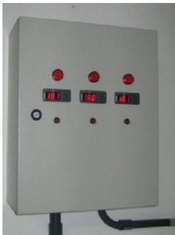
Figura 3.4 – Central de controle de automatização da temperatura.
